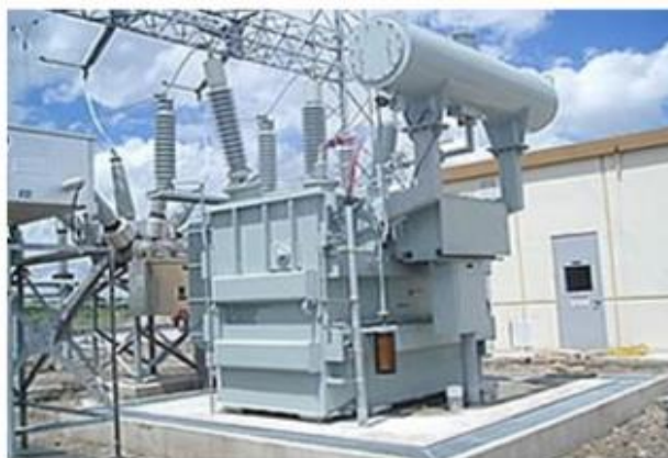
Figura 9. Subestación a la intemperie [24].
