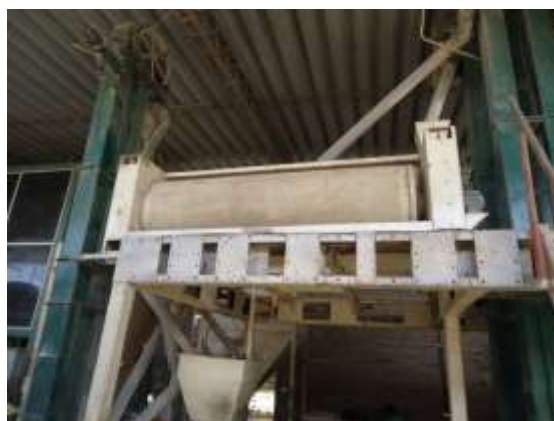
Figura 7: Maquinaria del Área de Clasificación
