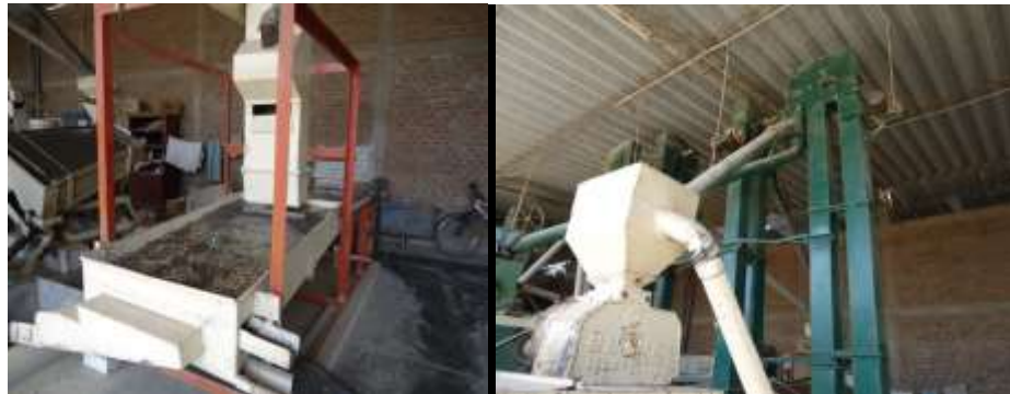
Figura 2: Maquinaria del Área de Prelimpia
