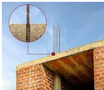
Figura 4 Acero expuesto al ambiente [16]
