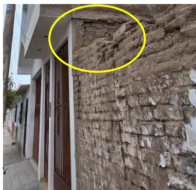
Figura 9 Vivienda con mal asentado del muro
