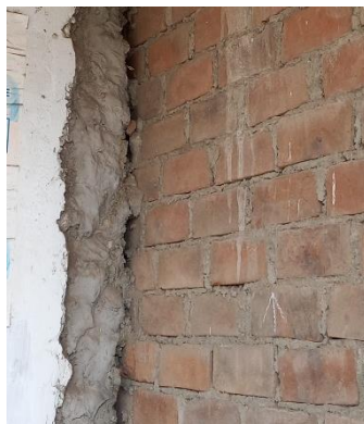
Figura 8 Vivienda con tabique sin columna
