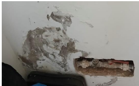
Figura 10 Vivienda con filtración de agua
