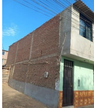
Figura 6 Vivienda con muros sin confinar
