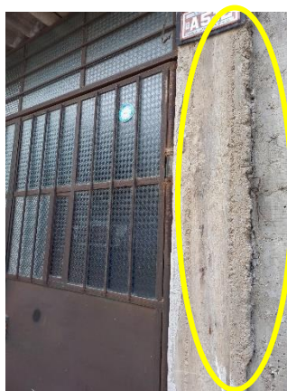
Figura 7 Vivienda sin junta sísmica
