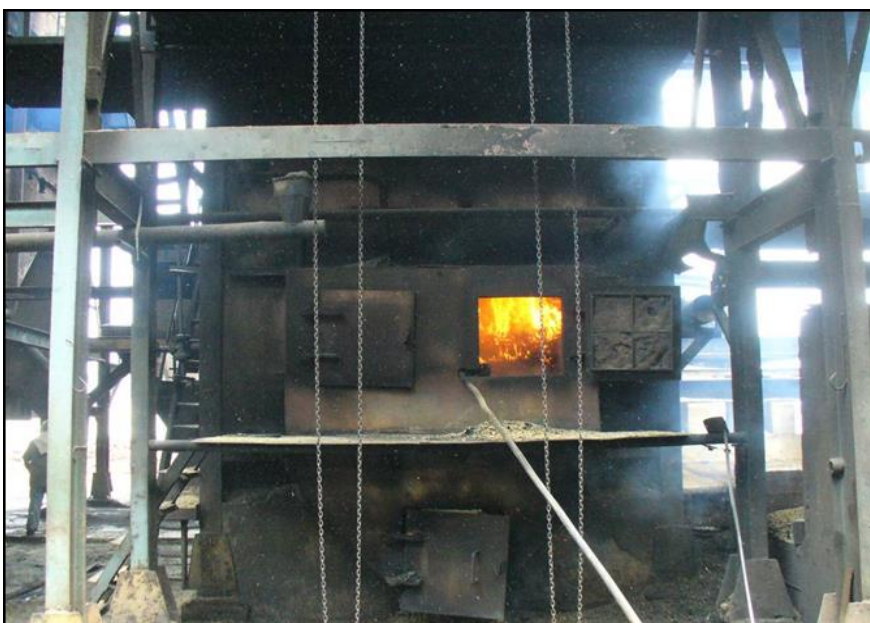
Figura 12: Zona de calderas.
