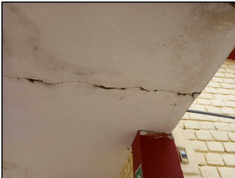
Anexo 1: Grietas identificadas en la I.E San Carlos
