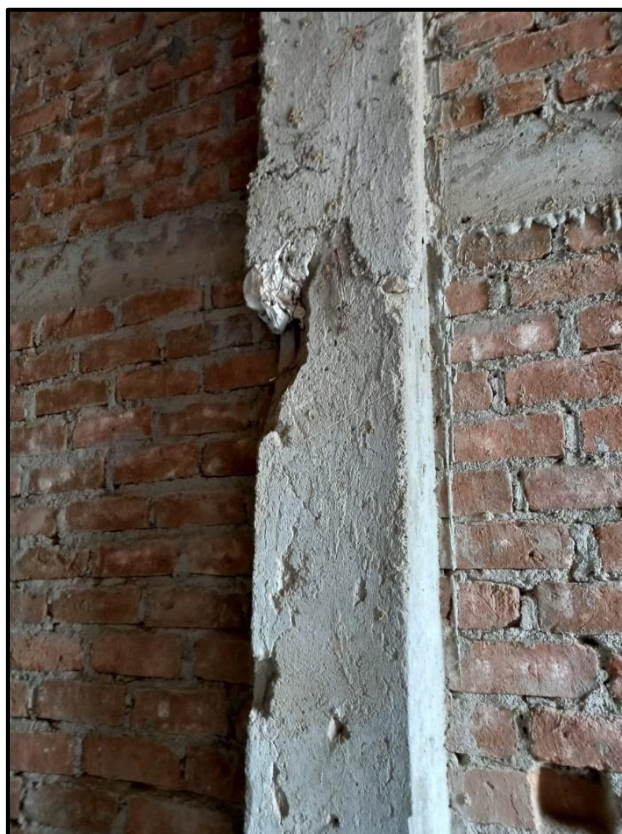
Anexo 4: Erosión identificada en la I.E San Carlos
