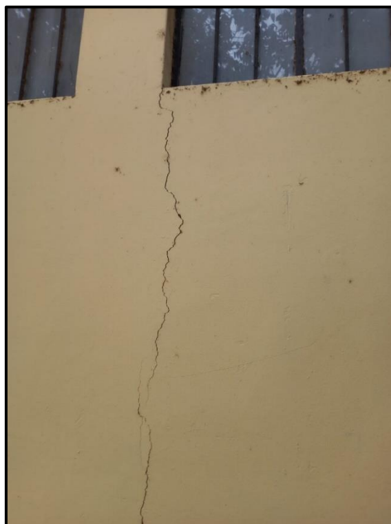
Anexo 2: Fisuras identificadas en la I.E San Carlos
