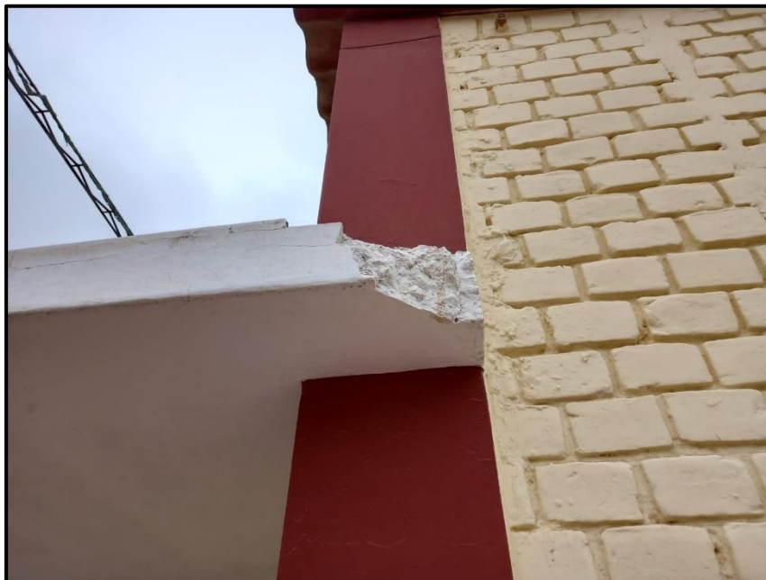
Anexo 3: Erosión identificada en la I.E San Carlos
