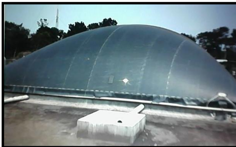
Figura 25. Pozo de control para la descarga del efluente del biodigestor.
