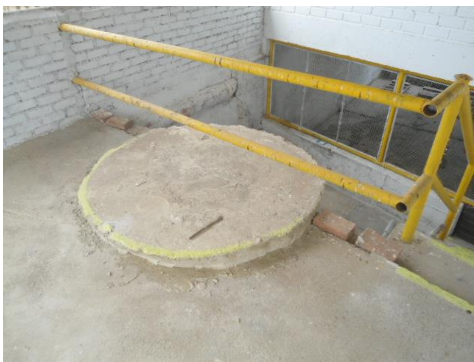
Figura 17. . Pozo tubular de la empresa productora de ron (Parte 2)
