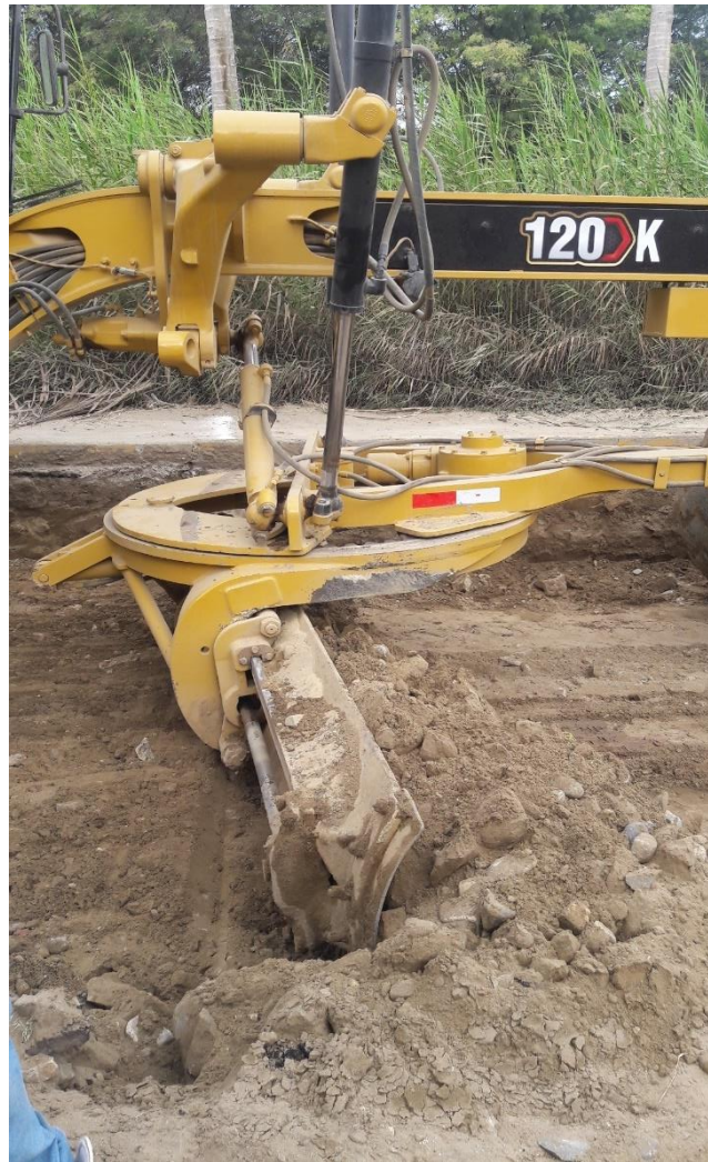
Foto 50. Motoniveladora prepara el suelo para que ingrese el rodillo liso Fuente: Propia
