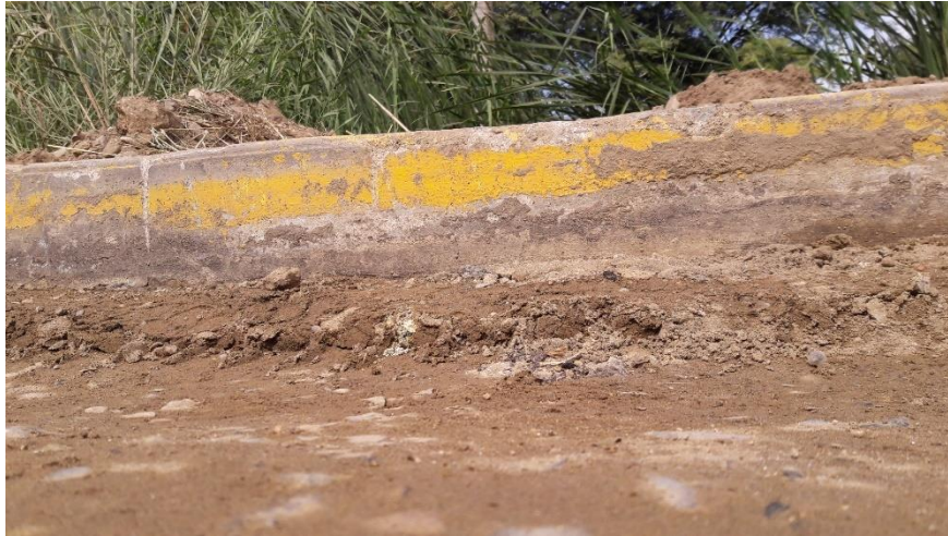
Foto 82. Espesor restante para la carpeta asfáltica Fuente: Propia
