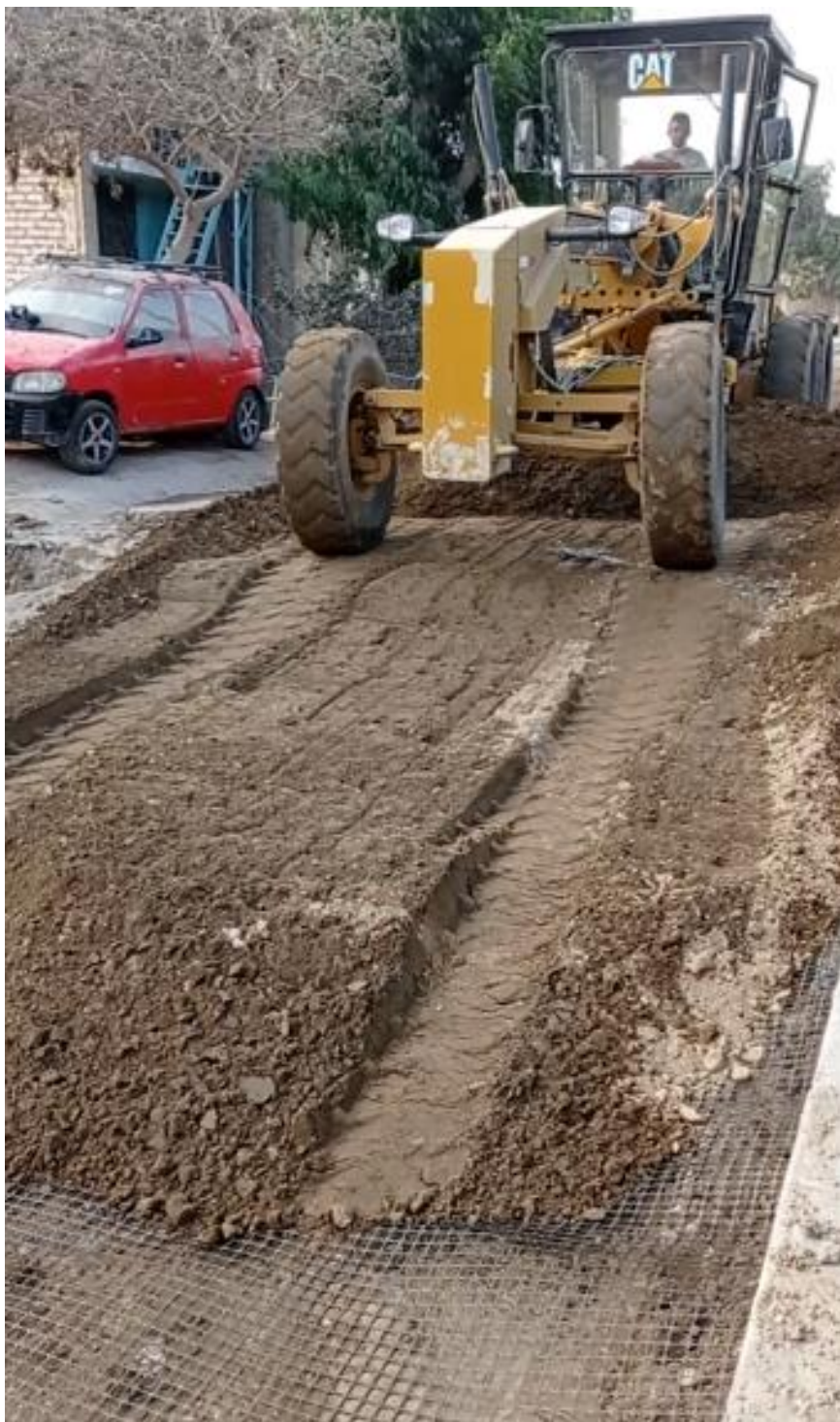
Foto 57. Geomalla biaxial queda entre la interfaz de la subrasante y subbase Fuente: Propia
