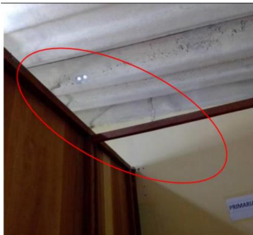
Figura. Presencia de aberturas en techo de almacén
