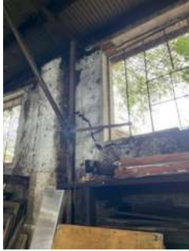
Figura 20. Deterioro de columna y pared
