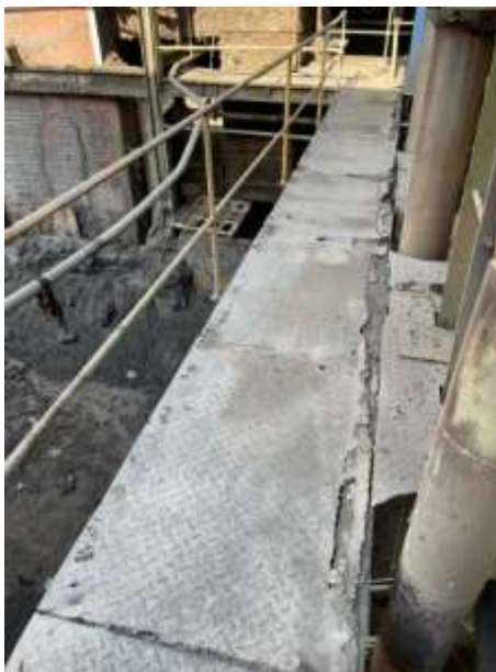
Figura 18. Planchas de metal deterioradas
