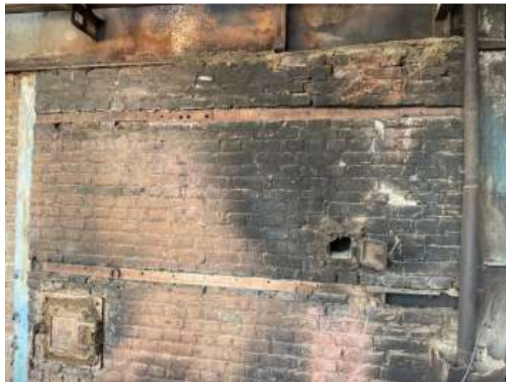
Figura 10. Pared deteriorada exterior a la caldera n°1
