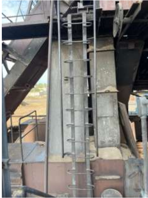
Figura 9. Escalera vertical sin canastilla de protección
