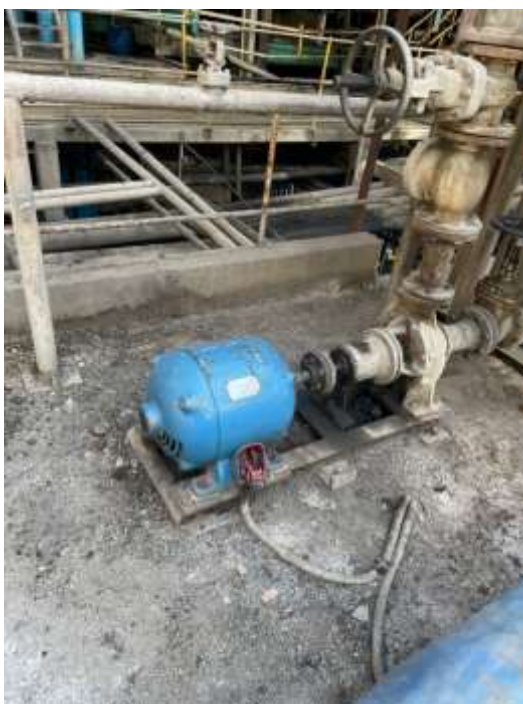
Figura 17. Acople sin guarda de protección Fuente: Investigación de campo
