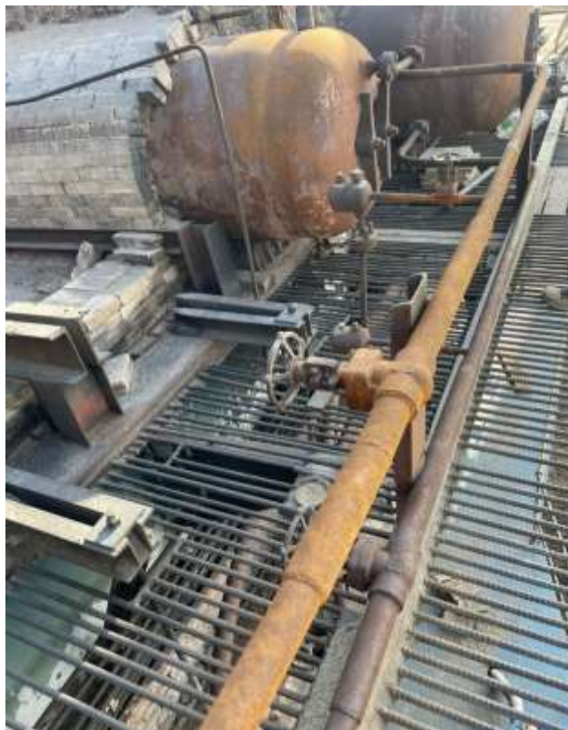
Figura 11. Tubería de alimentación y niveles de agua caliente
