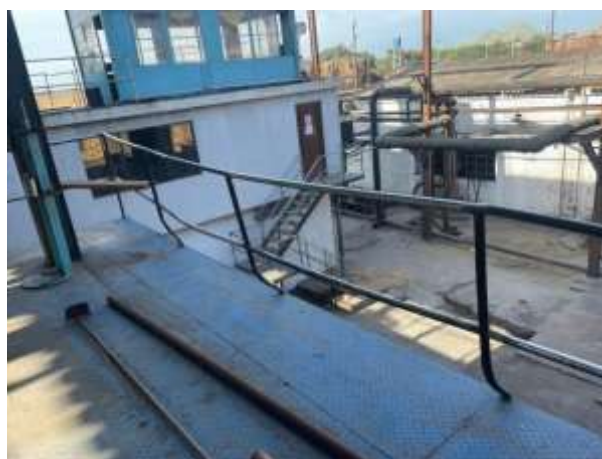
Figura 8. Baranda de seguridad inestable
