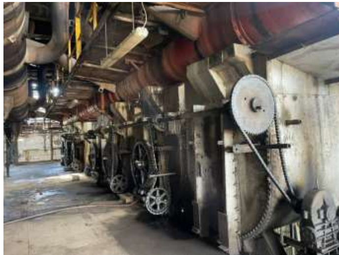
Figura 13. Cadenas de transmisión sin guardas de seguridad Fuente: Investigación de campo
