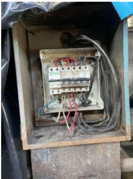
Figura 16. Cables expuestos del tablero eléctrico de los cristalizadores Fuente: Investigación de campo
