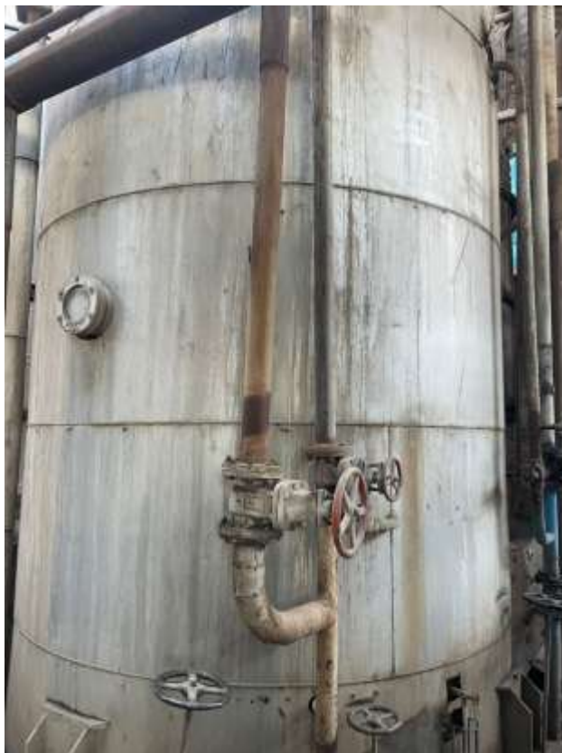
Figura 14. Tubería de agua caliente de evaporador sin aislamiento térmico
