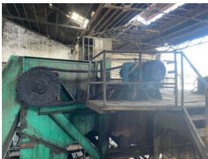
Figura 4. Cadena de transmisión del conductor n°4 sin guarda de protección
