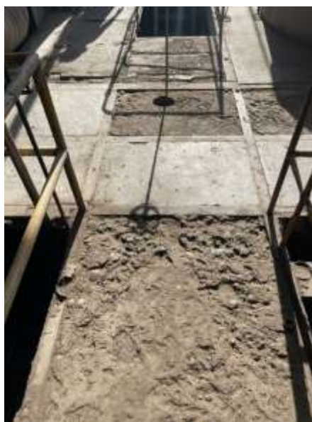
Figura 15. Piso deteriorado de desplazamiento de personal
