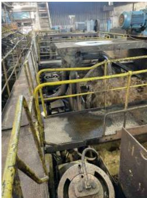
Figura 7. Charcos en los pasillos y barandas de seguridad en mal estado
