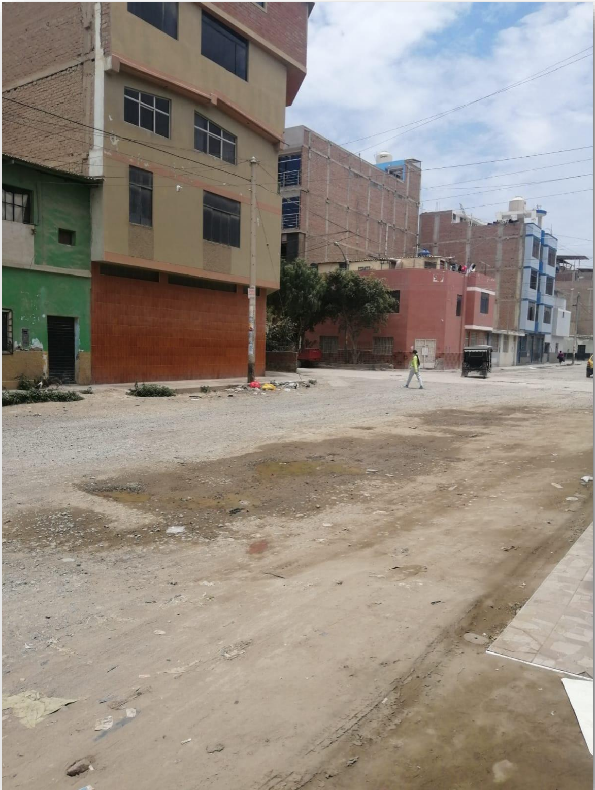
Fotografía 3: Estado actual del pavimento en la calle Colectora Urb. San Carlos.
