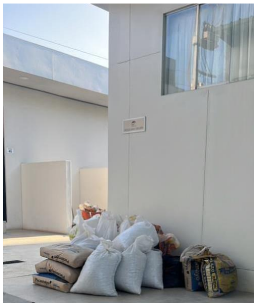
Figura 5. Material cemento portland tipo MS fortimax en almacenamiento
