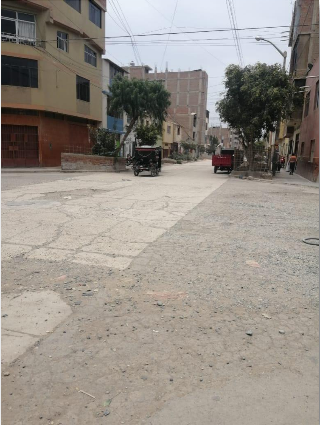
Fotografía 4: Estado actual del pavimento en la calle Colectora Urb. San Carlos.
