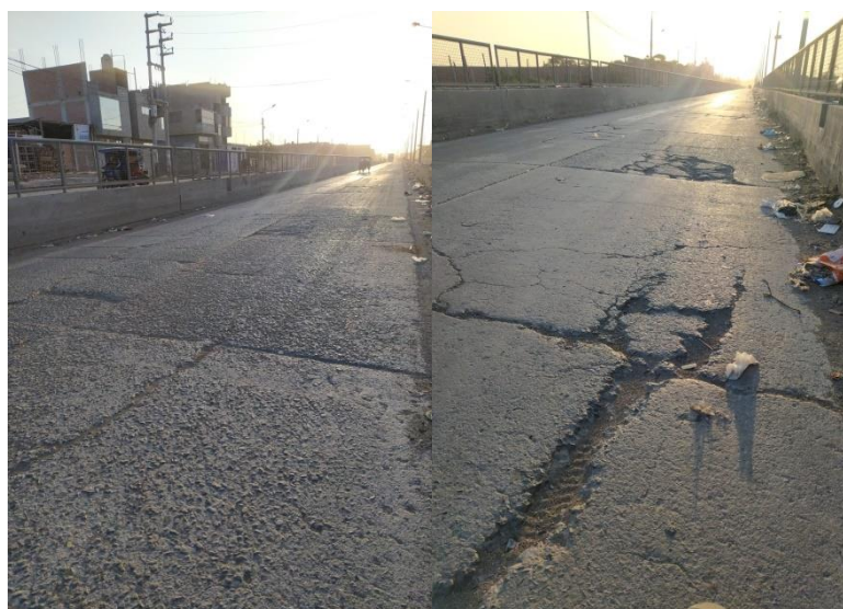
Figura 1. Fisuramientos y agrietamientos de paños de losa de concreto de pavimento rígido.
