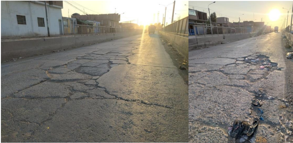
Figura 2. Bacheos y ahuellamiento en paños (losa de concreto de pavimento rígido).
