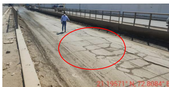
Figura 1 Deterioro de Pavimento Rígido en Av. Chiclayo intersección con Carlos Llosa y Llosa.
