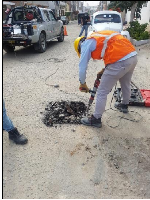
Fotografía 1: Ruptura de la carpeta de asfáltica (Calicata N°1)
