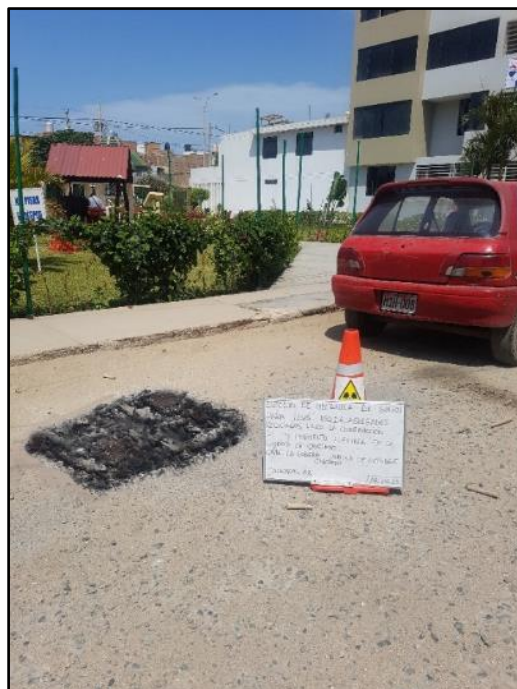
Fotografía 6: Ruptura de la carpeta asfáltica (Calicata N°2)
