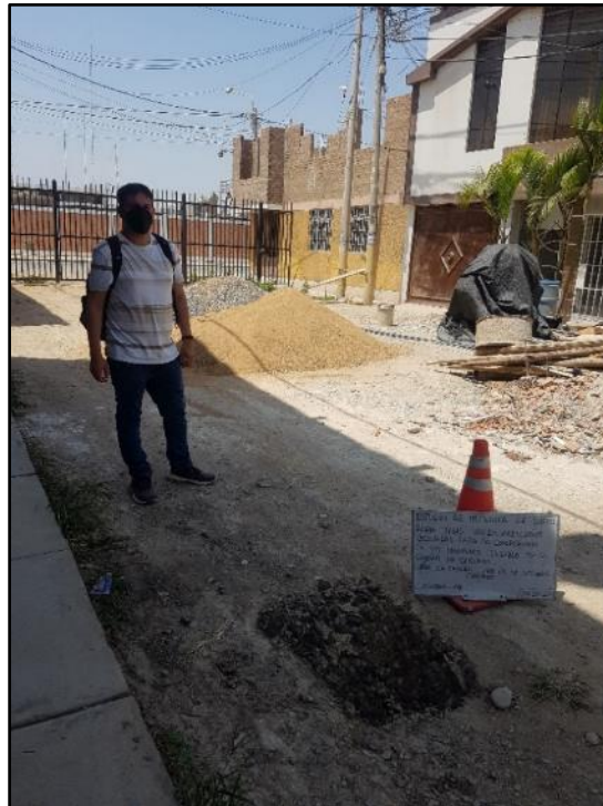
Fotografía 14: Ruptura de la carpeta asfáltica (Calicata N°5)
