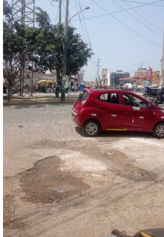
Figura 8. Fallas estructurales de la pavimentación flexible en la zona de estudio.
