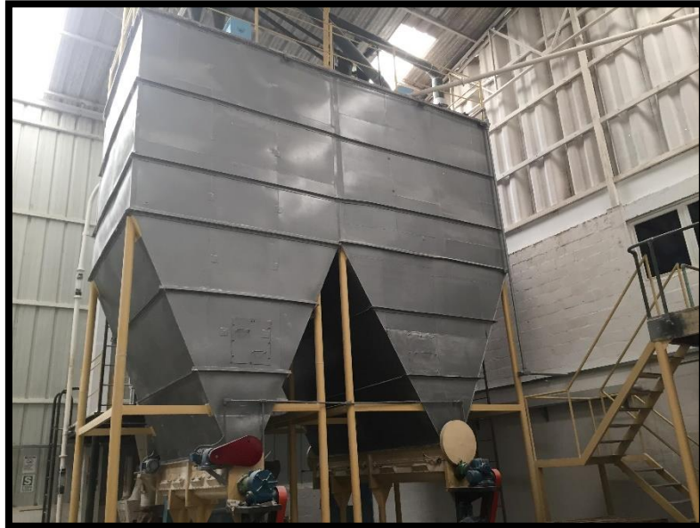
Figura 13. Equipo de almacenamiento final
