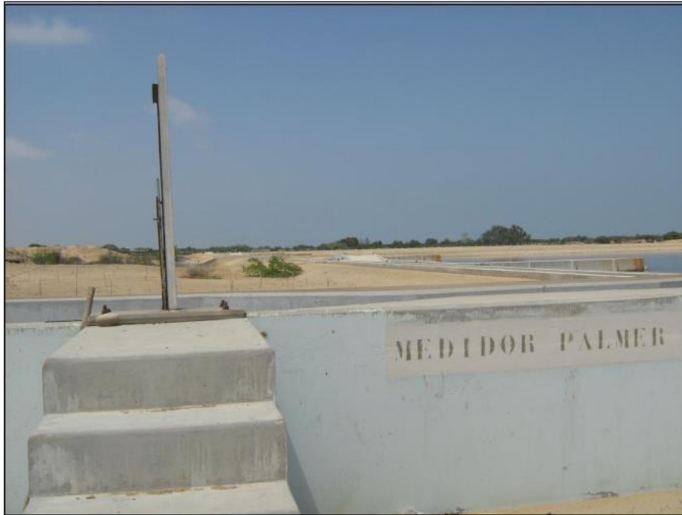
Fig. 27. Medidor de Caudales Parshall
