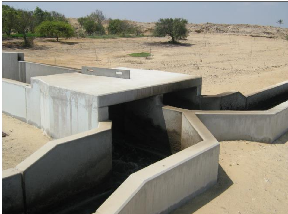
Fig. 28. Caja de distribución de caudales.
