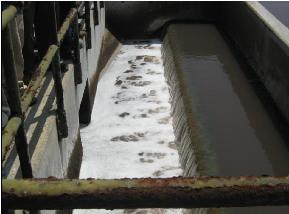
Fig. 30. Corrosión que provocan las aguas residuales. Los detergentes no son eliminados.
