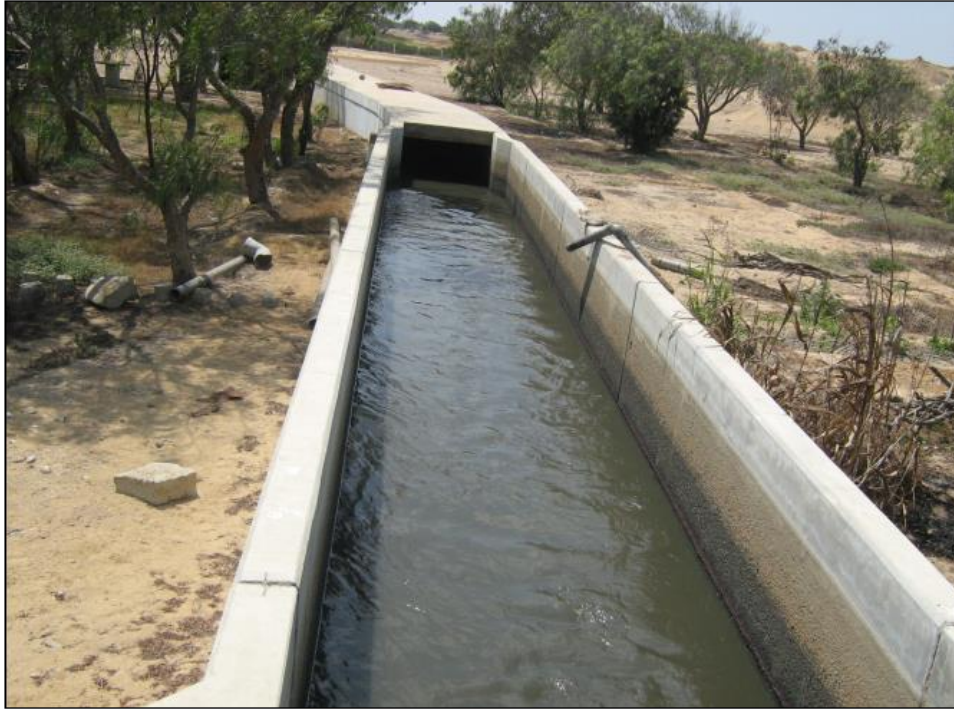
Fig.25. Canal de Ingreso de las Aguas Residuales.
