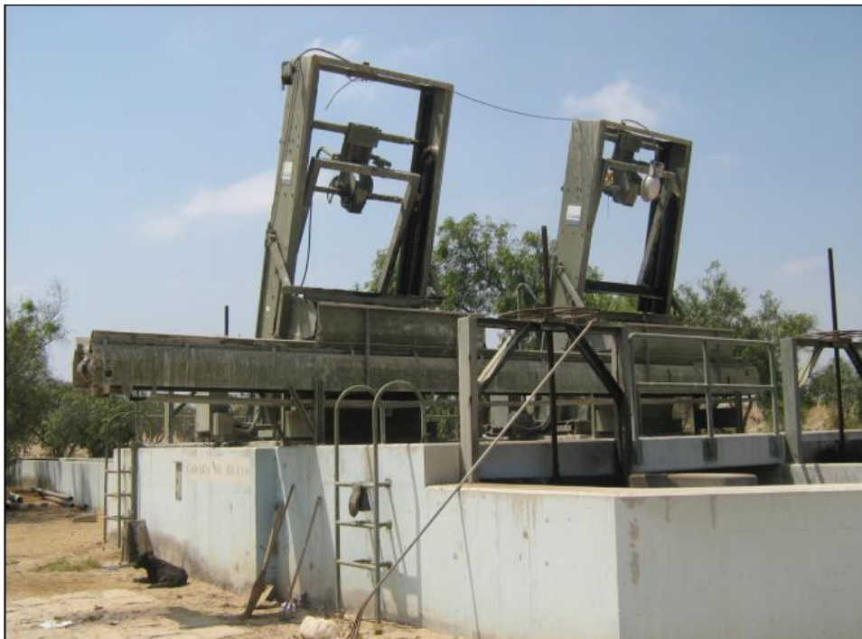
Fig. 26. Cámara de rejas automática.
