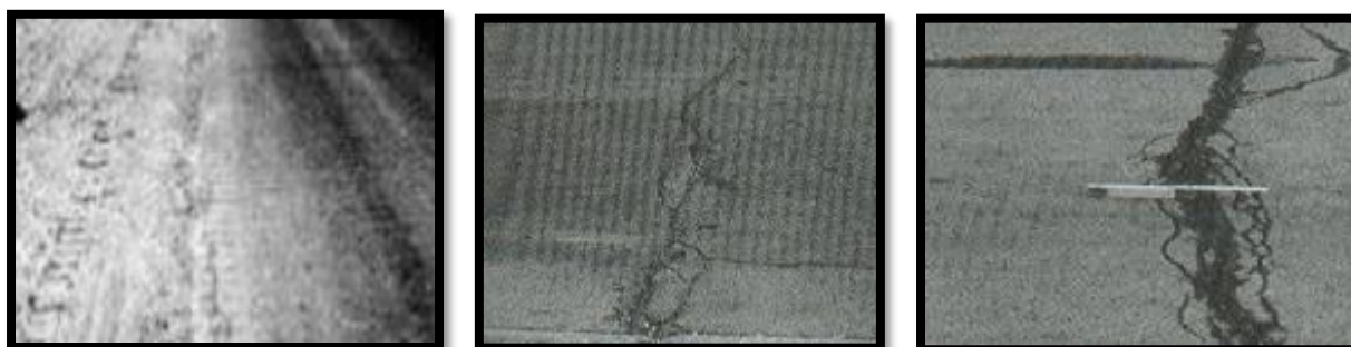
Ilustración 9. Grieta de reflexión de juntas: L, M y H
