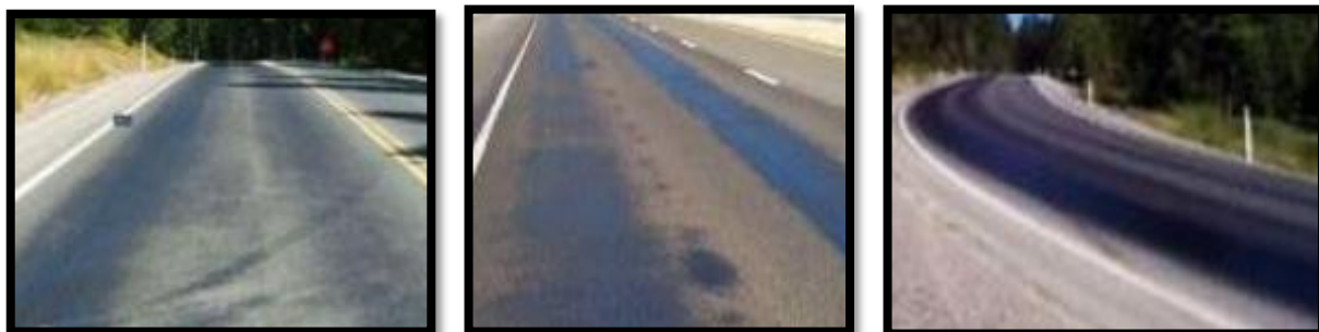
Ilustración 3 . Exudación del asfalto: L, M y H
