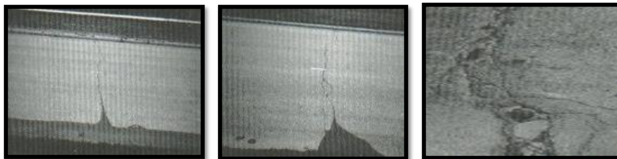
Ilustración 11. Fisuras longitudinales y transversales: L, M y H
