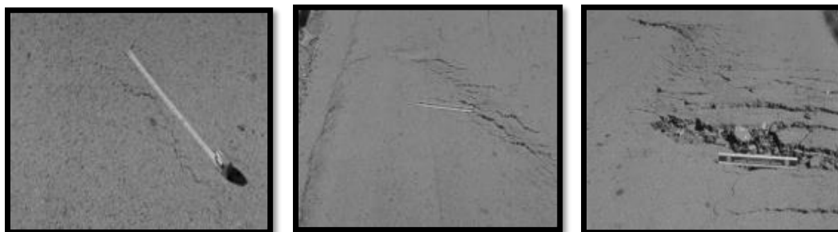
Ilustración 18. Fisuras parabólicas: L, M y H
