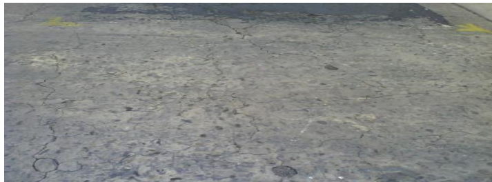
Fig. 2 Fisuración Tipo Malla en la Av. Santa Cruz - Lima
