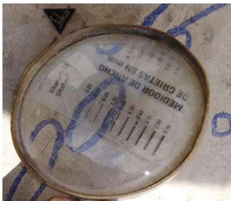
Fig. 37 Fisura de 0.10 mm de la muestra con Virutas
