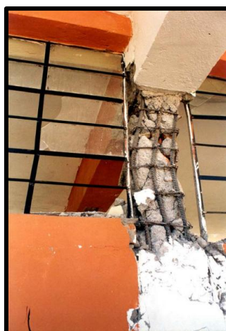
Fig. 139. Falla por efecto de columna corta [72].
