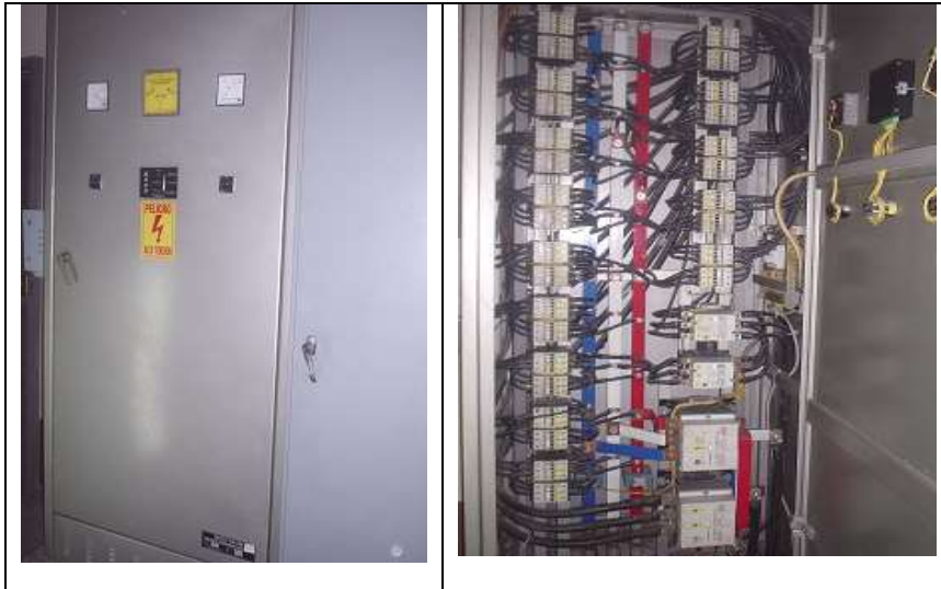
Figura N° 35: Tablero de transferencia y distribución.
