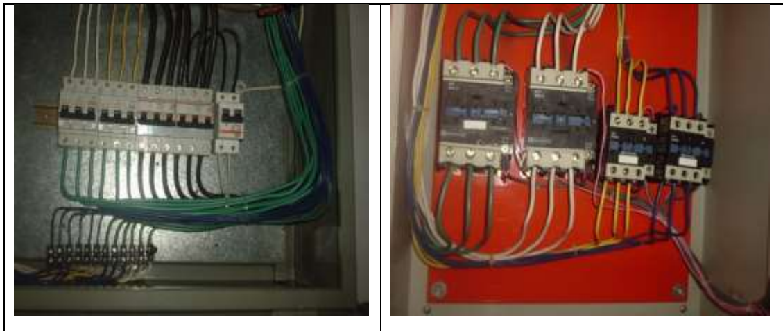
Figura N° 11. Tablero Comercial 220V A.C
