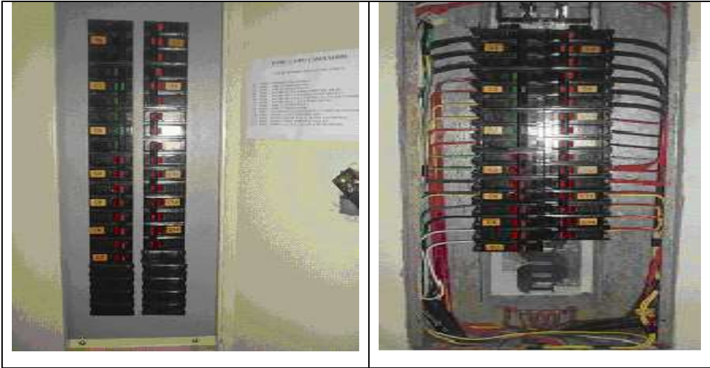
Figura N°15: Tablero Comercial 220V A.C
