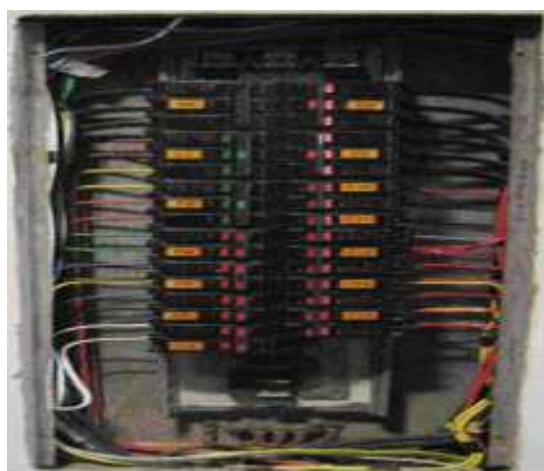
Figura N° 18: Tablero comercial 220V A.C
