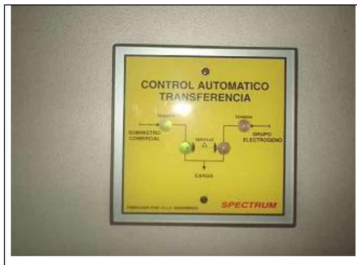
Figura N° 36: Modulo de transferencia automática.
