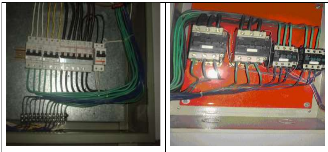
Figura N° 14: Tablero aire acondicionado 220V A.C
