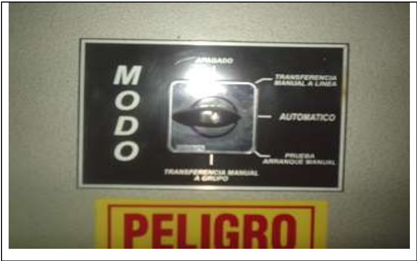
Figura N° 37: Selector de transferencia manual.
