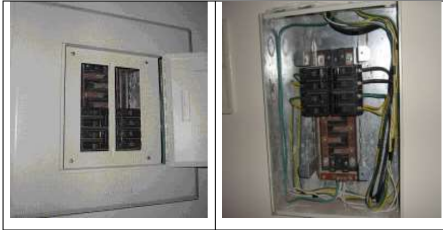
Figura N° 22: Tablero estabilizado 220V A.C
