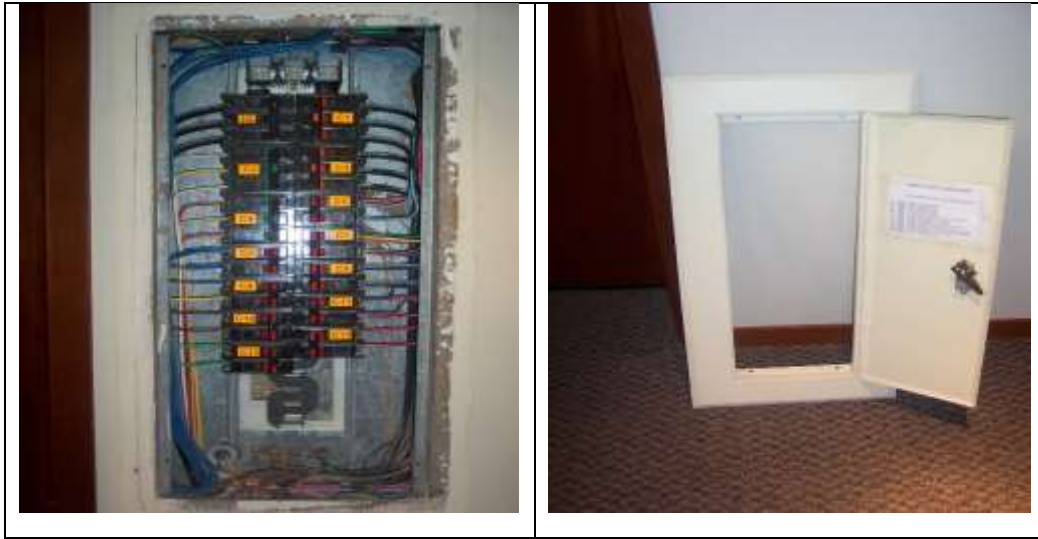
Figura N° 12: Tablero comercial 220V A.C
