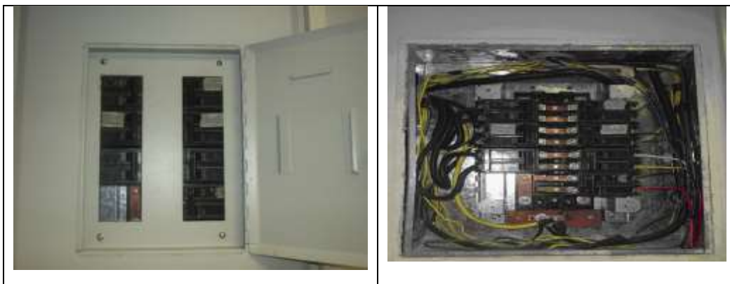
Figura N° 13: Tablero estabilizado 220V A.C
