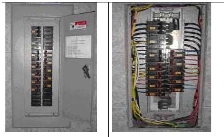
Figura N° 21: Tablero comercial 220 V A.C
