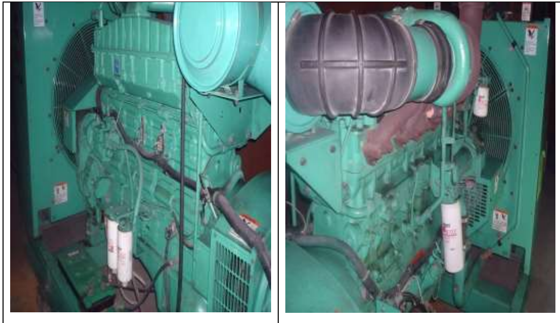
Figura N° 26: Motor y Generador.
