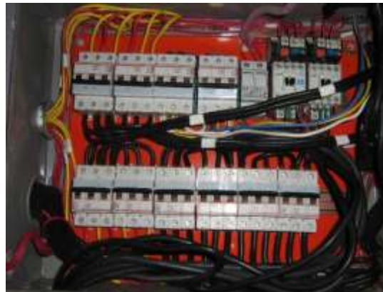
Figura N° 23: Tablero aire acondicionado 220V A.C
