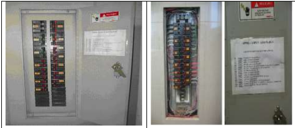
Figura N° 6: Tablero eléctrico comercial 220V AC.
