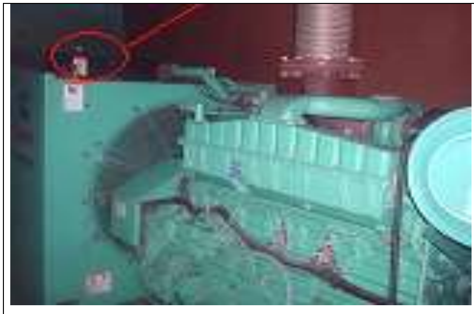
Figura N° 30: Sistema de enfriamiento.
