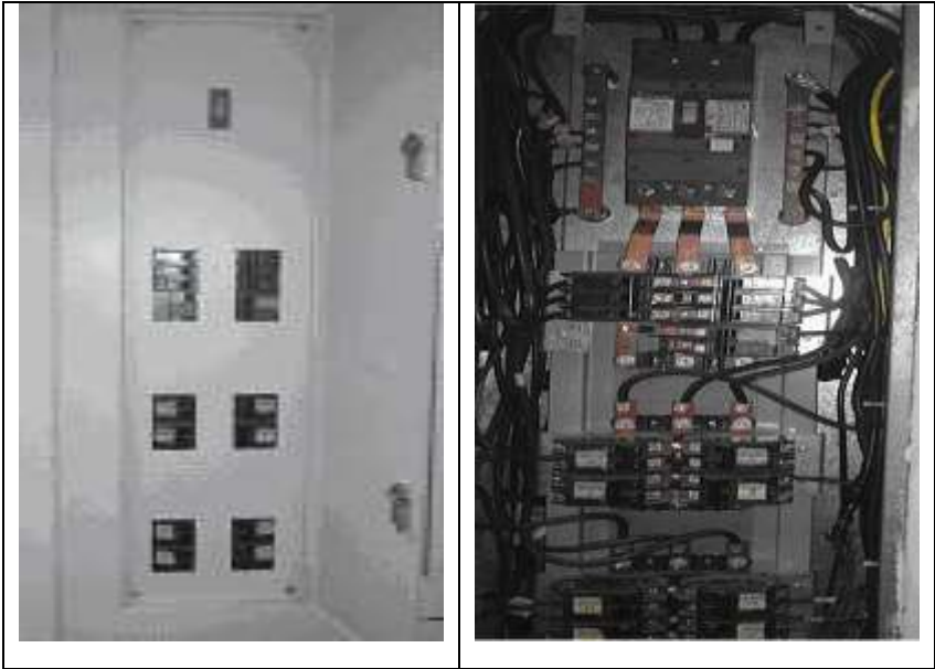
Figura N° 25: Tablero estabilizado para cada piso 220V A.C
