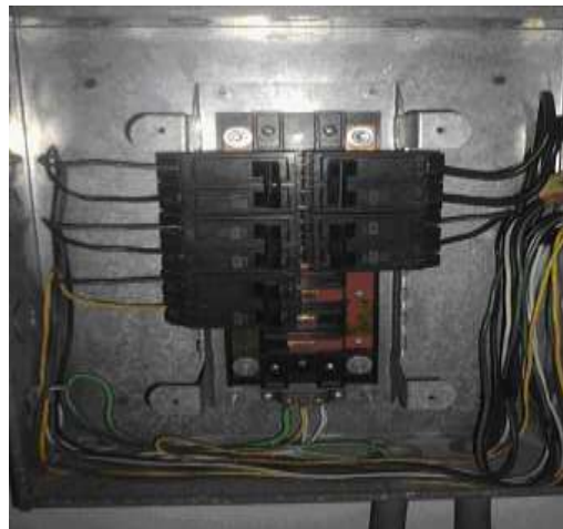
Figura N° 7: Tablero eléctrico estabilizado 220V AC.
