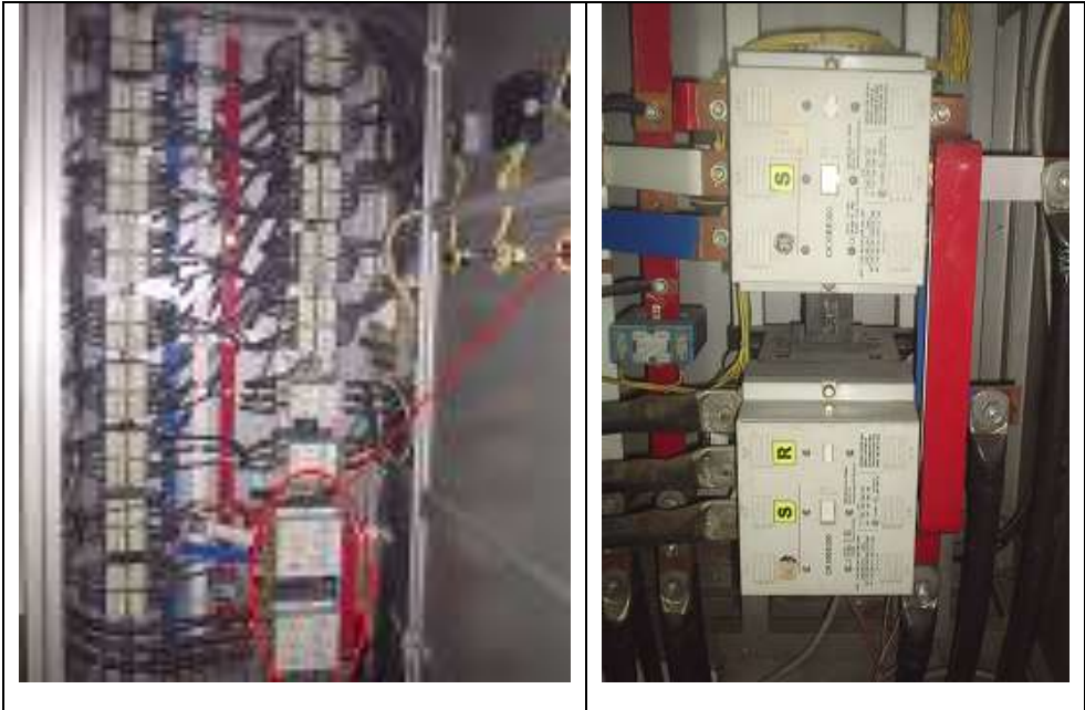
Figura N° 38: Contactores para servicios generales.
