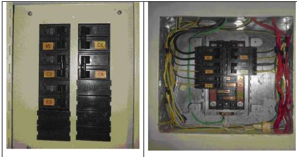
Figura N° 16: Tablero estabilizado 220V A.C
