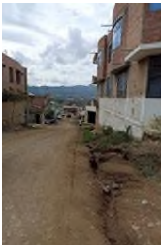
Fig. 3. Tramo en mal estado. Fuente: Propia.
