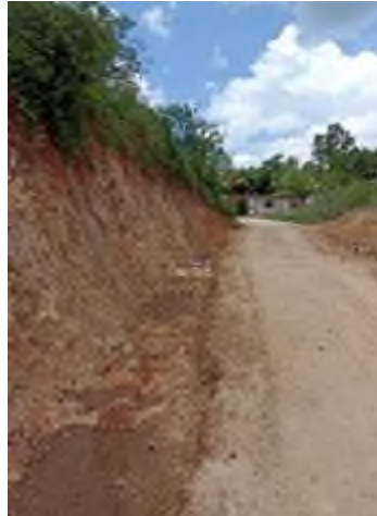
Fig. 5. Tramo con cunetas improvisadas. Fuente: Propia.
