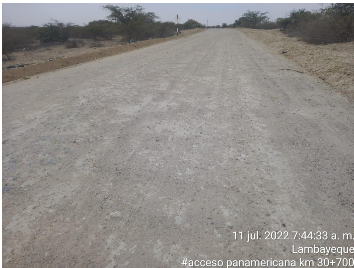
Ilustración 7. Estado Regular en tramos sin cloruro de calcio
