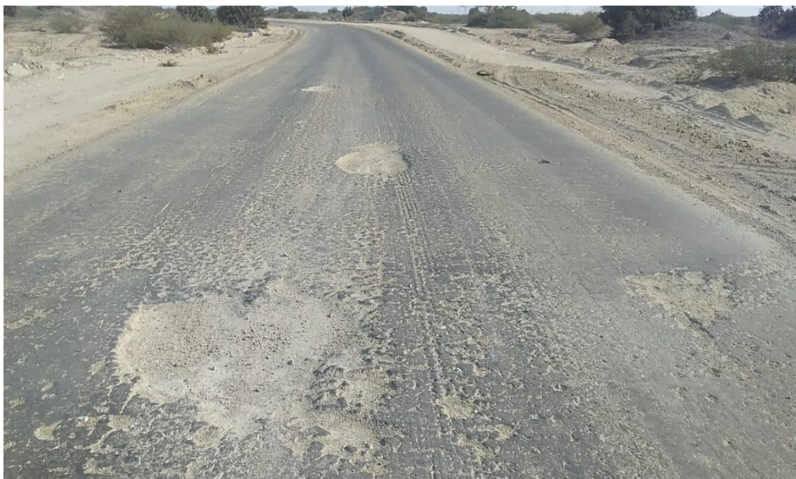
Ilustración 5. Estado Necesita Mantenimiento en tramos con cloruro de calcio
