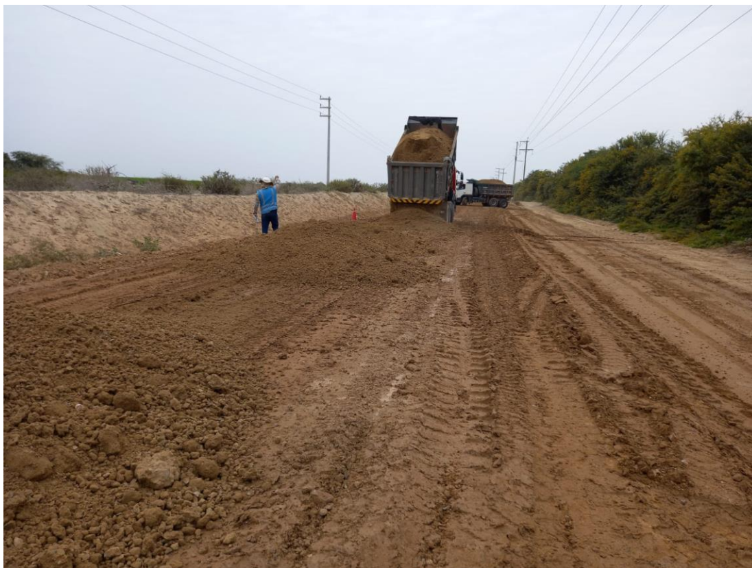
Ilustración 15. Colocación de afirmado en perfilado de la superficie con aporte de material
