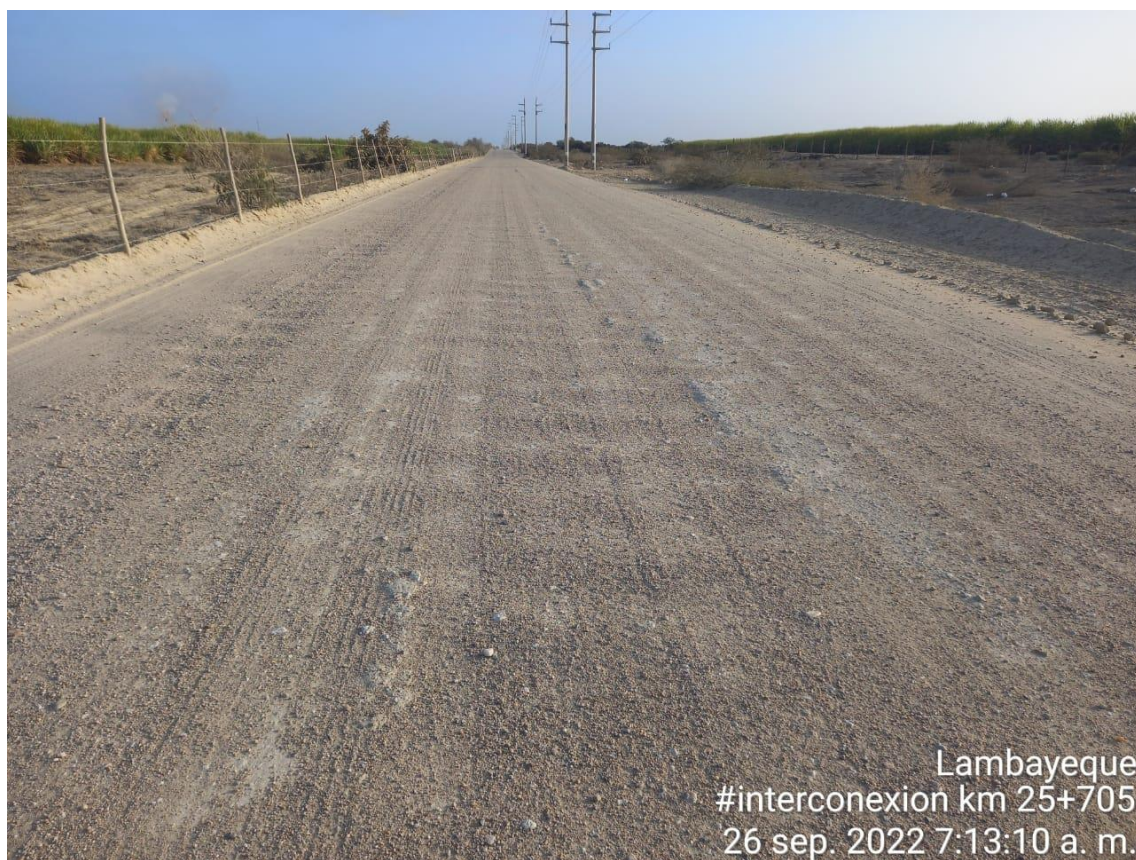
Ilustración 8. Estado Necesita Mantenimiento en tramos sin cloruro de calcio
