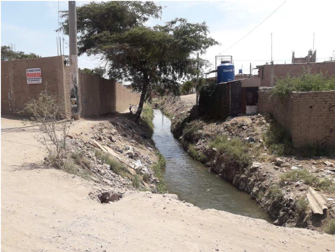
Foto 4.4 – Acequia Pulen y tramos contiguos degradados y de tránsito deficiente
