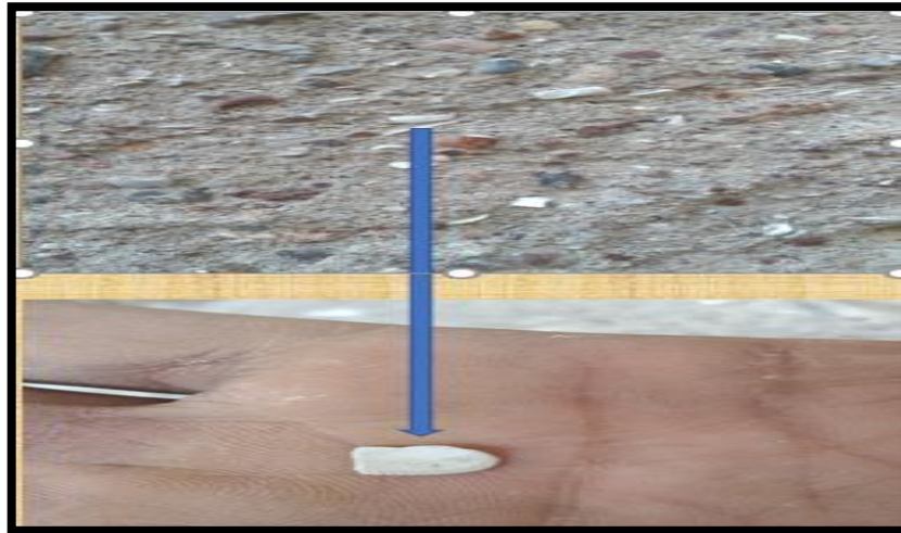
Figura 7: Se identifico la conchuela en los muros de concreto
