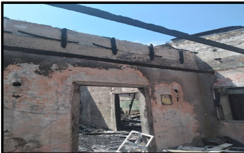
Figura 5: Viguetas incineradas luego del incendio
