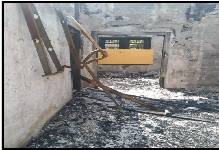
Figura 25: Muros y detalles incinerados
