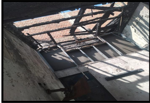
Figura 21: Viguetas del Techo Incineradas
