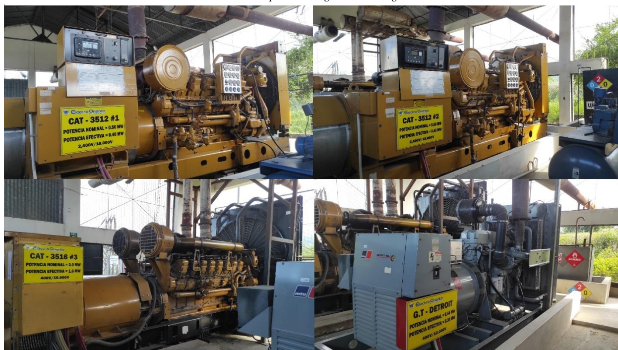
Ilustración 29 Grupos Electrógénos C.T. Bagua Grande
