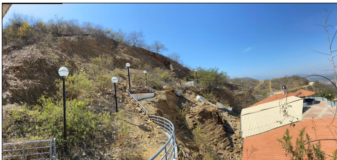
Figura 2. Vista general del deslizamiento en el cerro Chalpón
