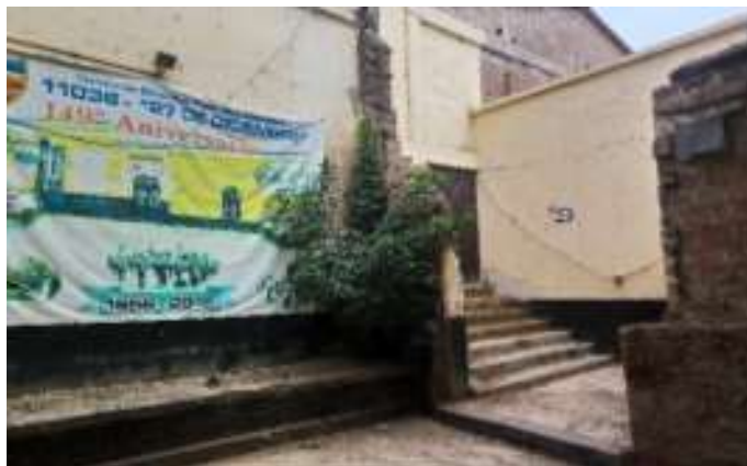
Figura 20. Desprendimiento de muros de adobe
