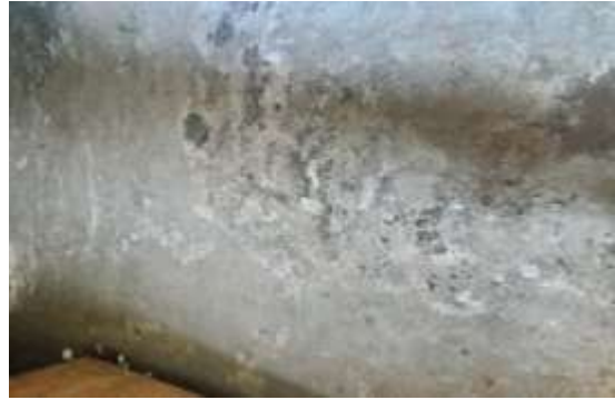
Figura 18. Eflorescencia de sal en pisos
