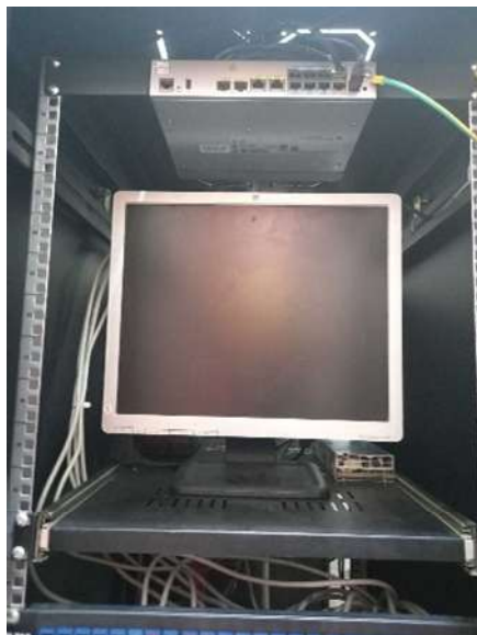
Fig. 23. Servidor en gabinete de piso en unidad de peaje.
