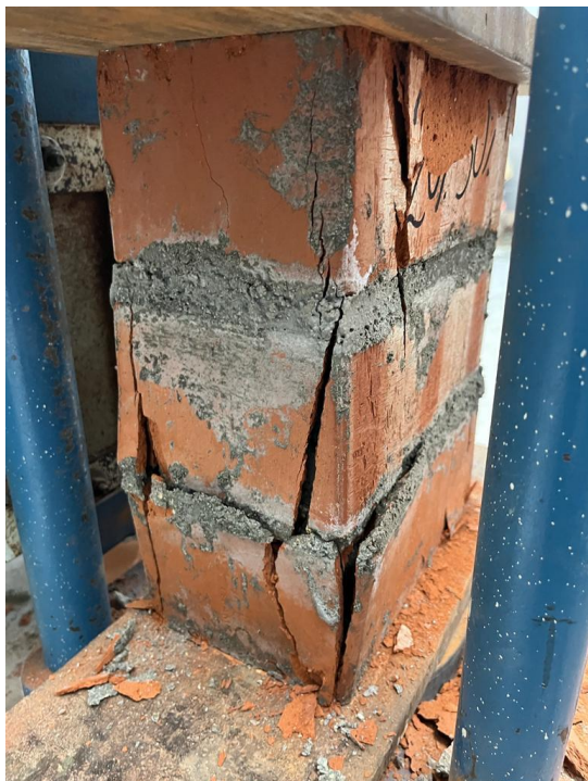
Imagen 91. Pila del 20 % Aserrín calcinado y 30% Concreto Reciclado – Falla por flexión
