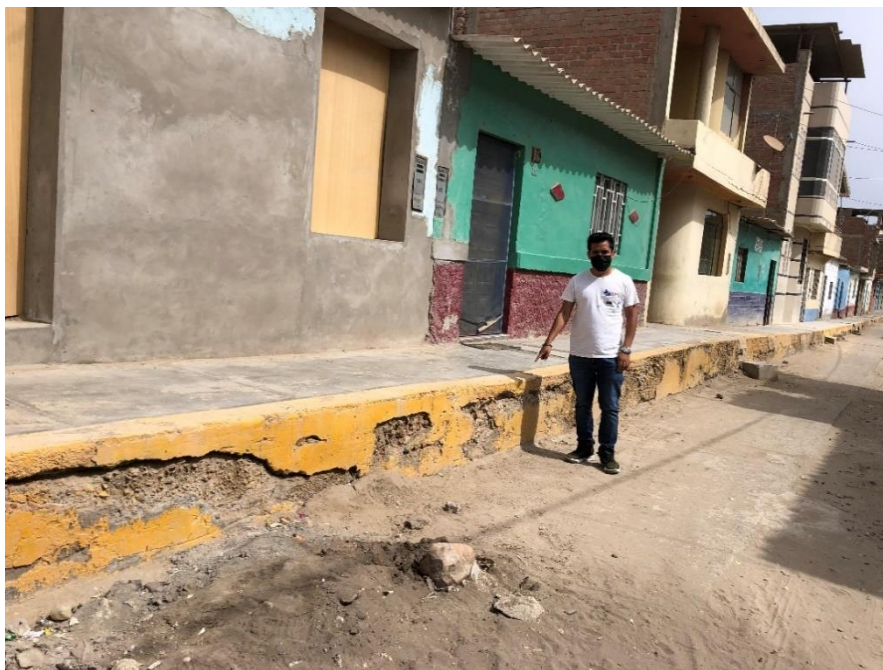
Imagen 4. Desprendimiento de Mortero en Veredas
