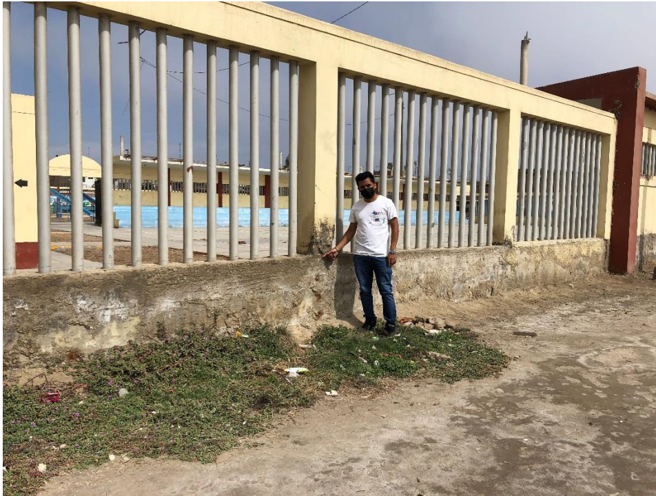
Imagen 3. Desprendimiento de Mortero en Fachadas
