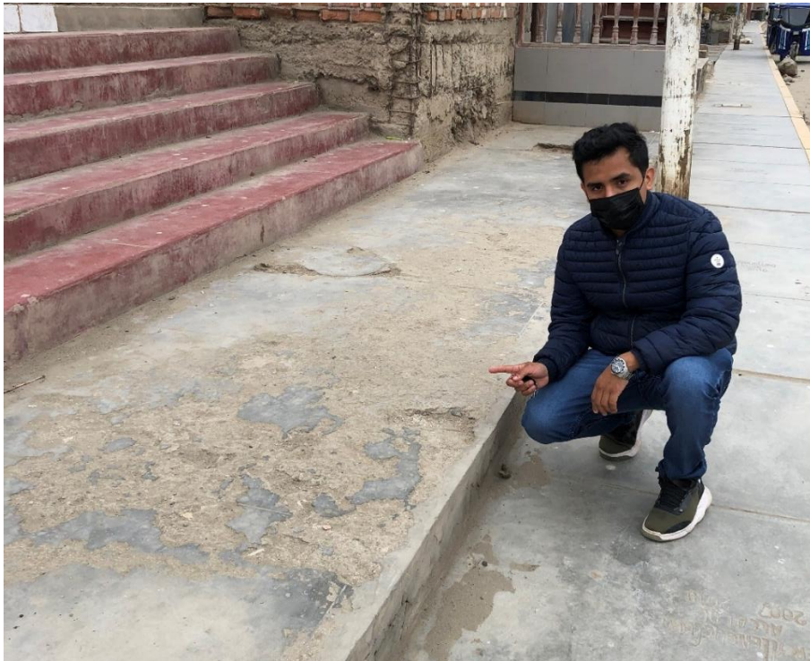
Imagen 5. Falta de mortero en Losa de Veredas
