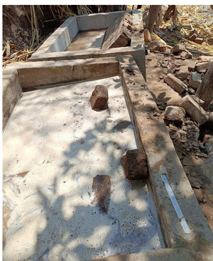
Ilustración 64 Muros después del colapso
