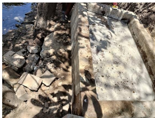
Ilustración 63 Colapso del muro con adición
