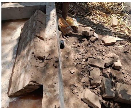
Ilustración 62 Colapso del muro patrón
