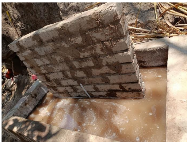
Ilustración 60 Muro expuesto a la inundación simulada
