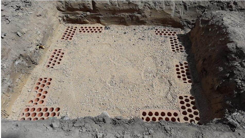
Figura 32. Agujero de losa
