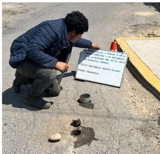
Ilustración 21 Extracción de muestra en zona agrietada de la calle Los Sauces.
