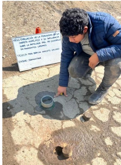
Ilustración 19 Extracción de muestra en zona agrietada de la calle Almirante Guisse.
