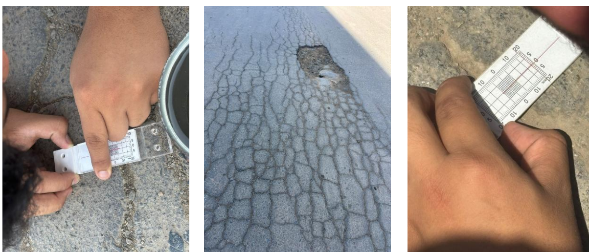
Ilustración 32 Análisis del nivel de severidad de las grietas.
