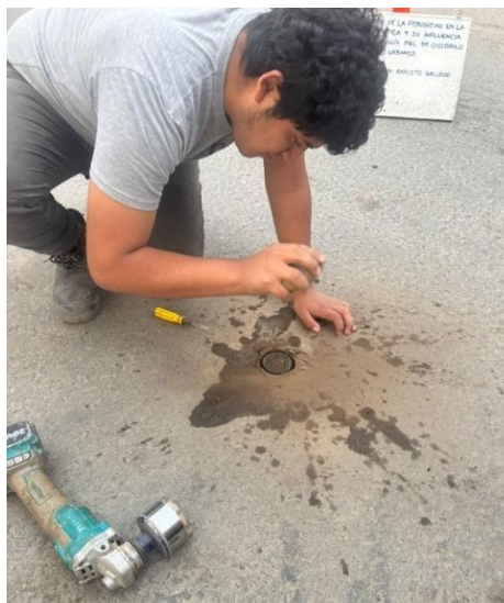
Ilustración 25 Extracción de muestra en zona no agrietada de la calle 7 de Enero Sur.
