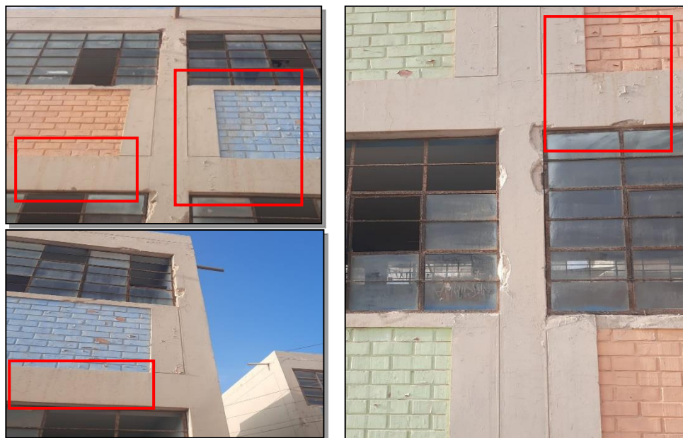
FIGURA 19: Presencia de suciedad en la fachada del bloque A
