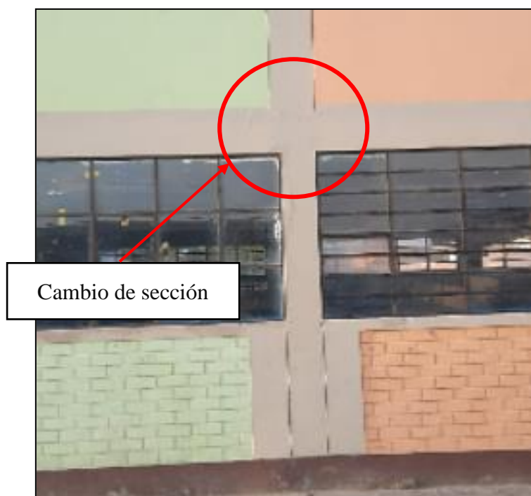
FIGURA 11: Discontinuidad en la columna del bloque B
