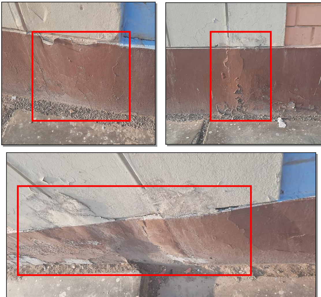
FIGURA 25: Deformación del sobrecimiento – Primer Nivel
