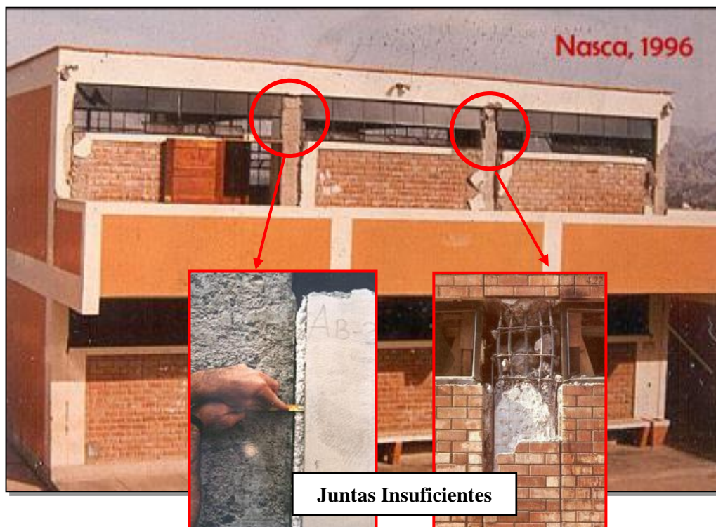
FIGURA 9: Colapso por problema de columna corta – Sismo de 1996 (Nasca)
