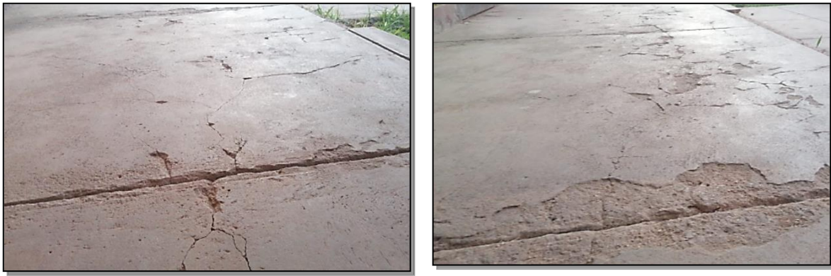
FIGURA 58: Erosión mecánica en las veredas
