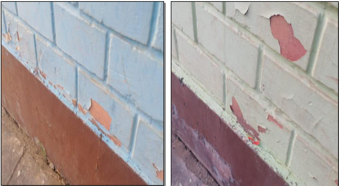
FIGURA 22: Presencia de humedad en los muros – Primer Nivel
