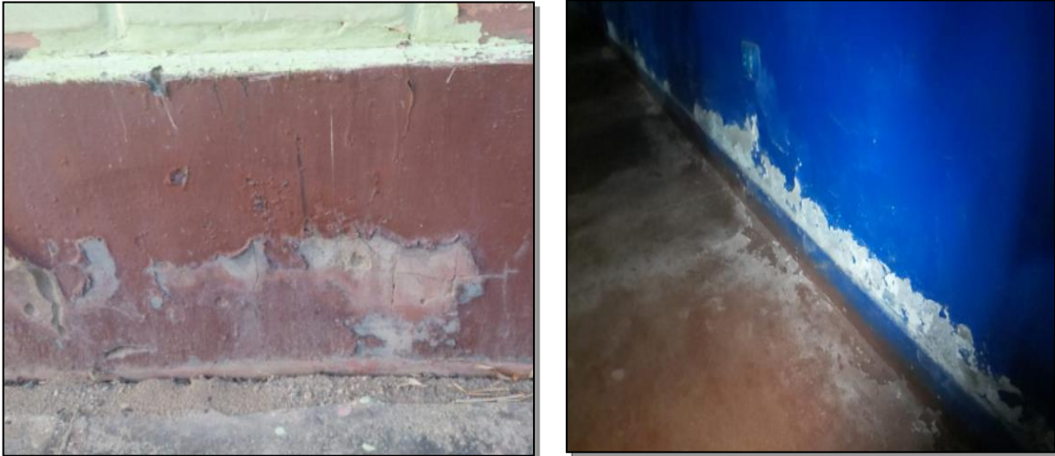
FIGURA 64: Eflorescencias en los sobrecimientos – Primer Nivel
