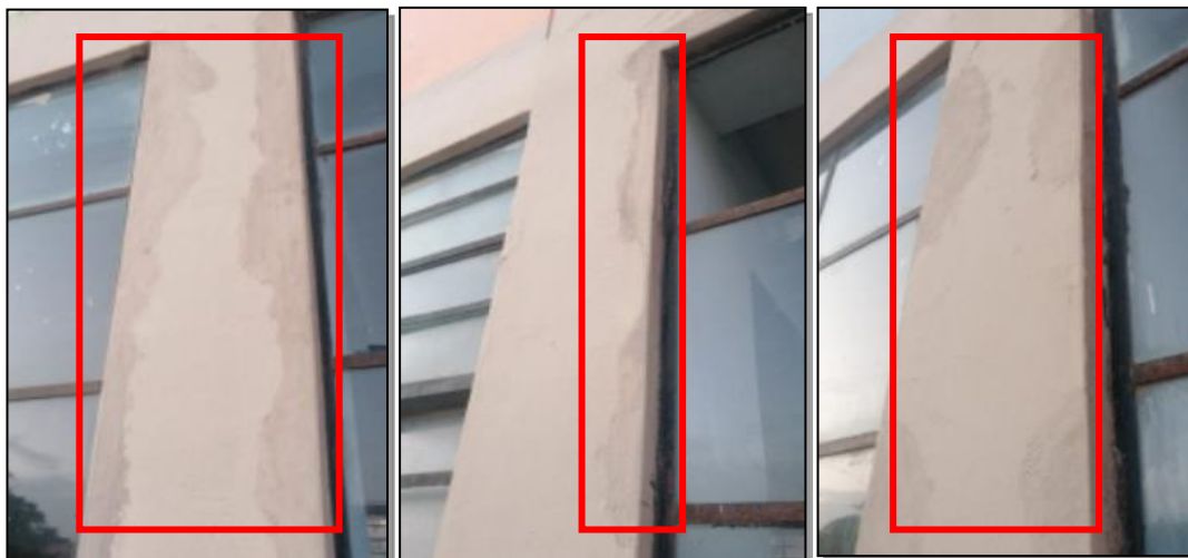
FIGURA 53: Reparación de las columnas por presencia de desprendimientos de concreto
