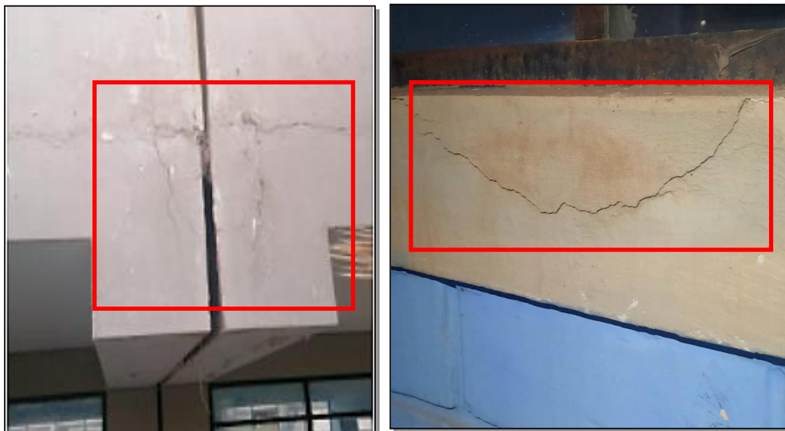
FIGURA 48: Fisuramiento de la viga solera y viga del voladizo – Primer y Segundo Nivel
