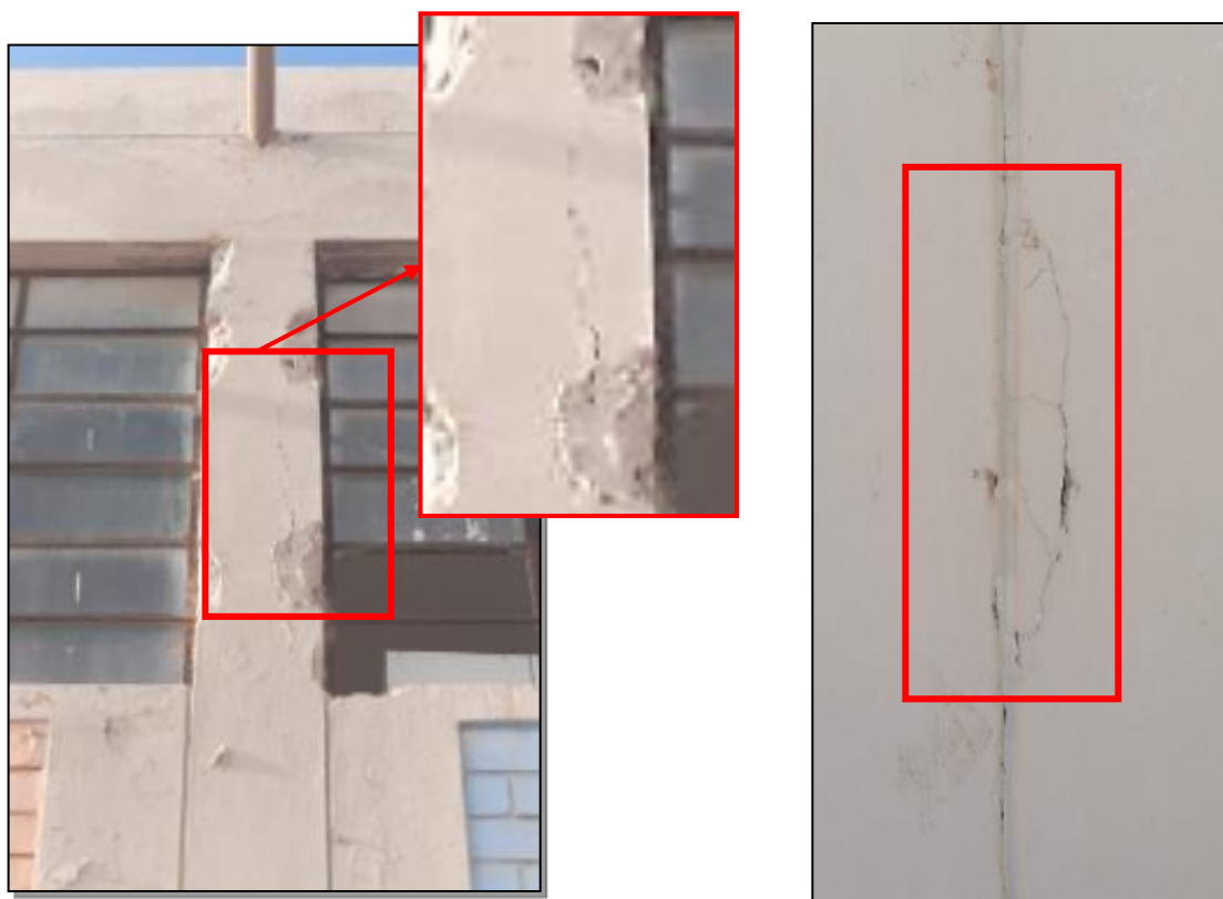
FIGURA 33: Fisuramiento de las columnas – Segundo Nivel
