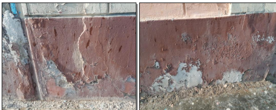
FIGURA 13: Presencia de humedad en los sobrecimientos – Primer Nivel
