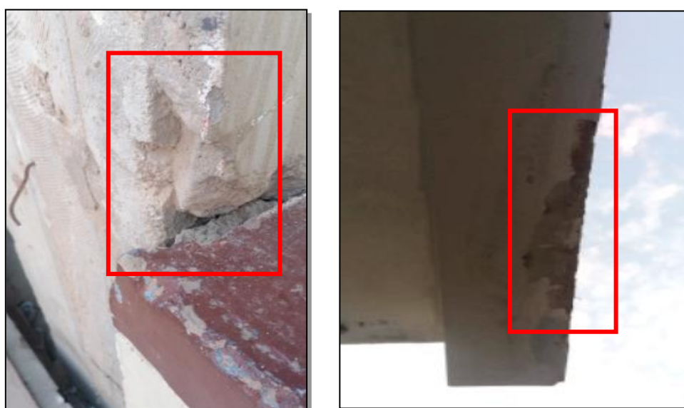
FIGURA 52: Desprendimiento del concreto en columnas y vigas– Segundo Nivel
