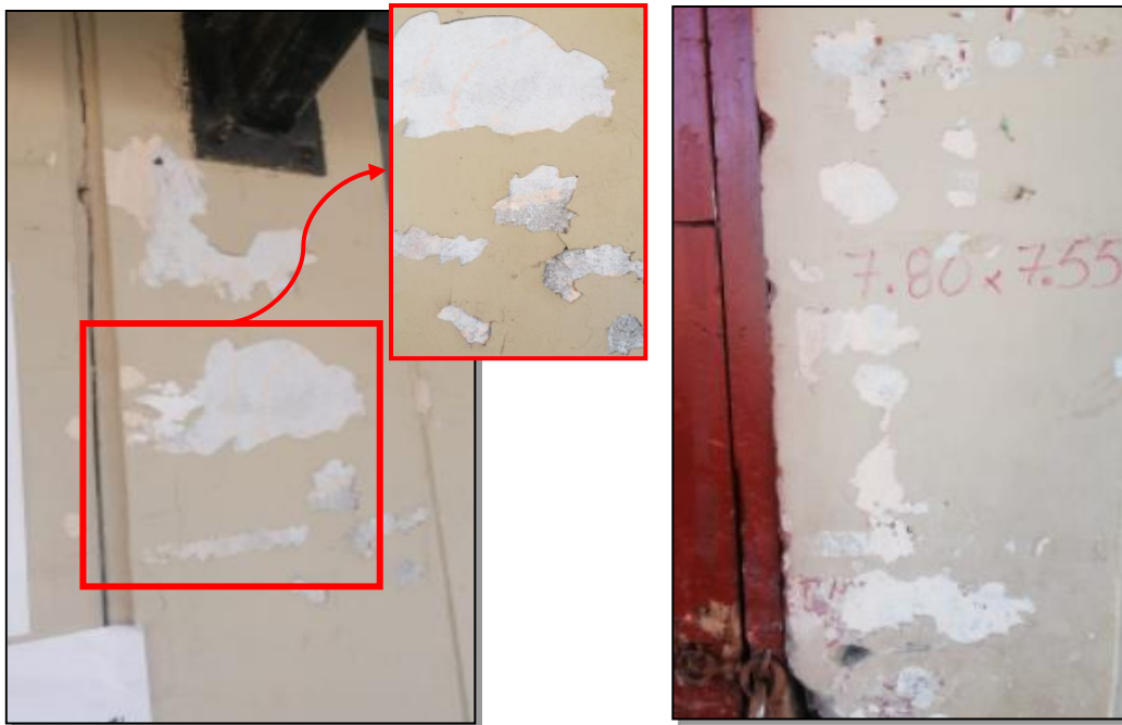
FIGURA 17: Presencia de humedad en los muros y columnas – Segundo Nivel
