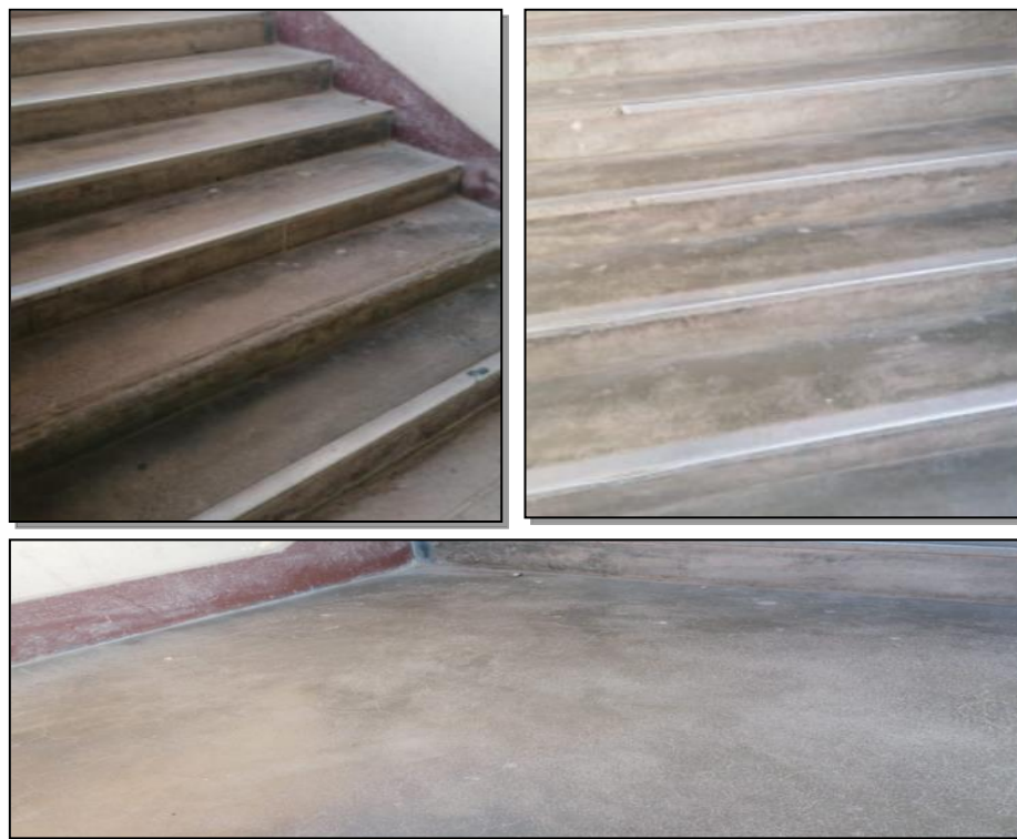
FIGURA 43: Erosión mecánica en las gradas de las escaleras
