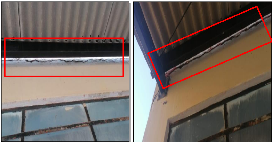
FIGURA 31: Vista frontal del Agrietamiento de losa– Segundo Nivel
