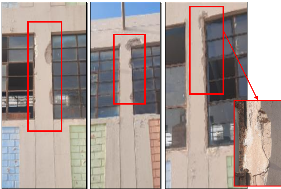
FIGURA 37: Desprendimiento del concreto de las columnas
