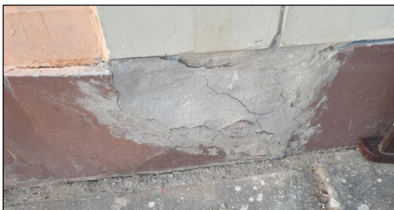
FIGURA 54: Reparación de los sobrecimientos por presencia de desprendimientos de concreto
