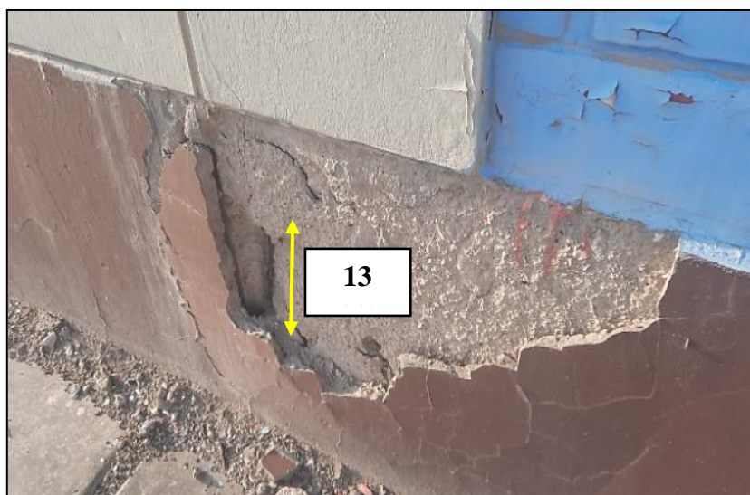
FIGURA 61: Oxidación y corrosión del acero en sobrecimientos – Primer Nivel
