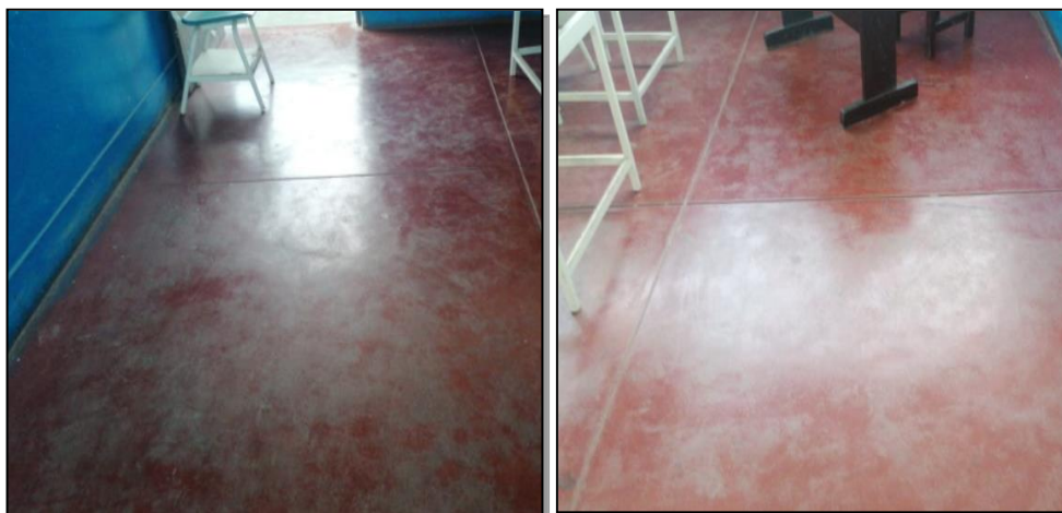
FIGURA 55: Erosión mecánica en los suelos de las aulas
