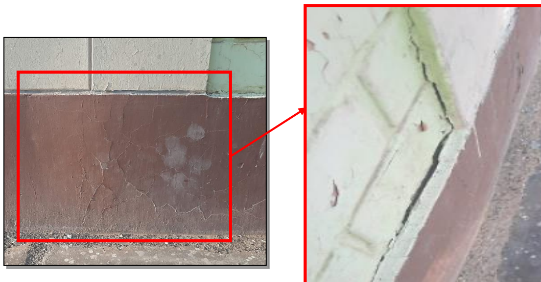
FIGURA 26: Separación del muro con el sobrecimiento – Primer Nivel
