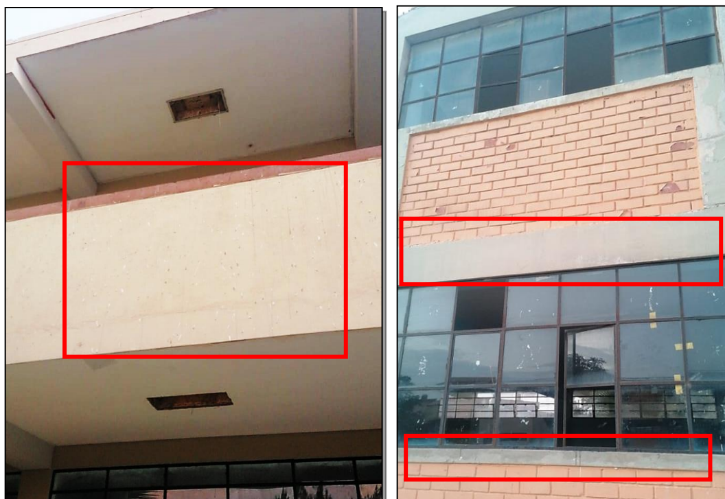
FIGURA 24: Presencia de suciedad en la fachada del bloque B
