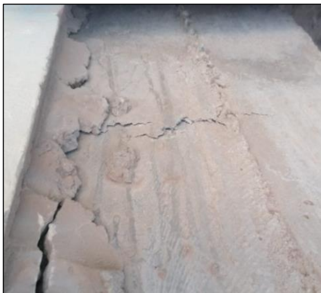
FIGURA 47: Agrietamiento de la columna – Segundo Nivel
