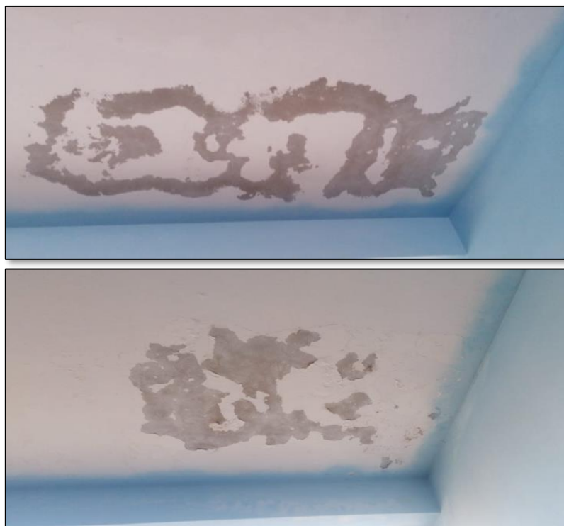
FIGURA 18: Presencia de humedad en las losas – Segundo Nivel
