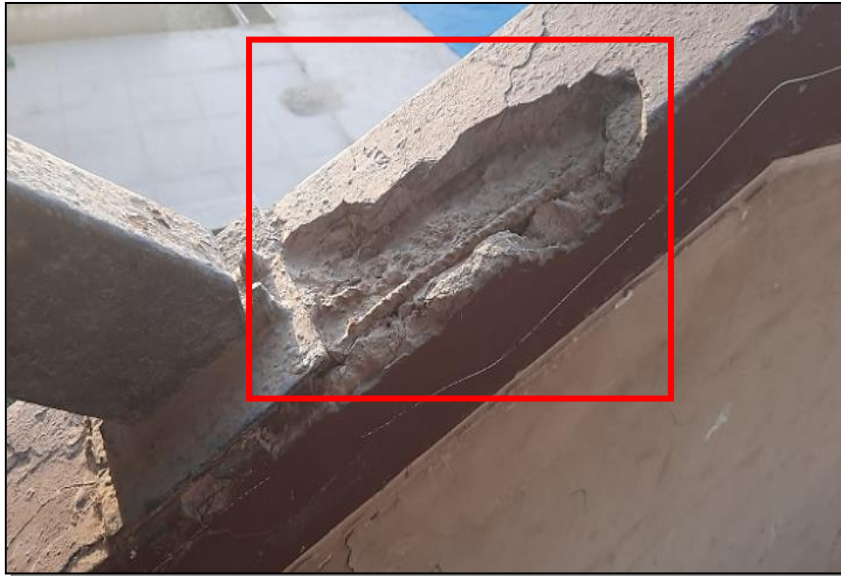
FIGURA 62: Oxidación y corrosión del acero en el pasamanos de escaleras
