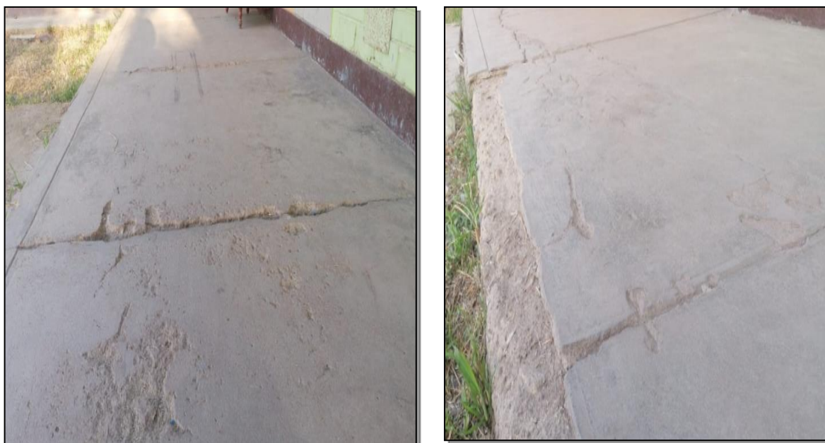
FIGURA 42: Erosión mecánica en las veredas
