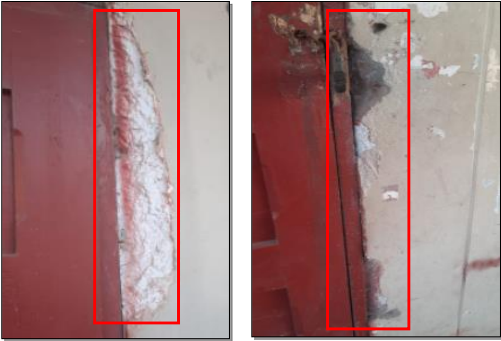
FIGURA 38: Desprendimiento del concreto en los bordes de la puertas
