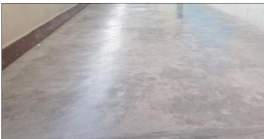
FIGURA 57: Erosión mecánica en los pasadizos – Segundo Nivel
