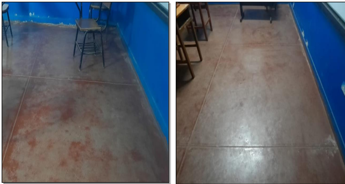
FIGURA 41: Erosión mecánica en los suelos de las aulas
