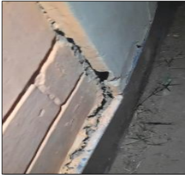
FIGURA 45: Separación del muro con el sobrecimiento
