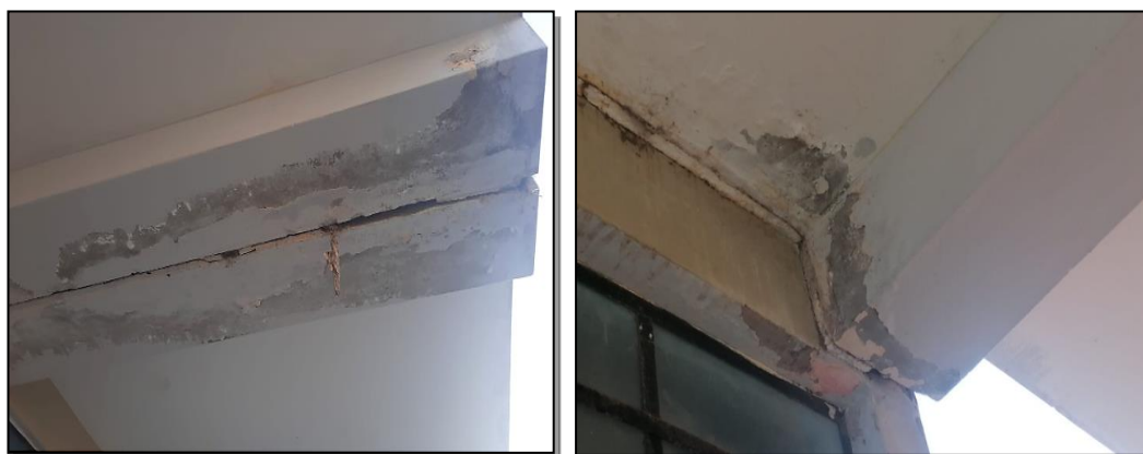
FIGURA 12: Presencia de humedad en las vigas de voladizo – Primer Nivel
