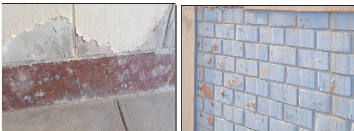
FIGURA 15: Descascaramiento de la pintura de los muros debido a la presencia de humedad – Primer Nivel
