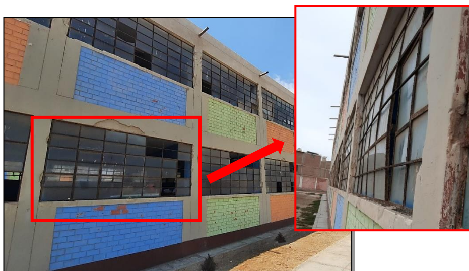
FIGURA 27: Posible deformación de columnas del bloque A
