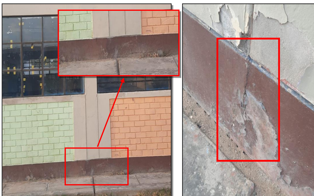
FIGURA 44: Deformación del sobrecimiento del bloque B
