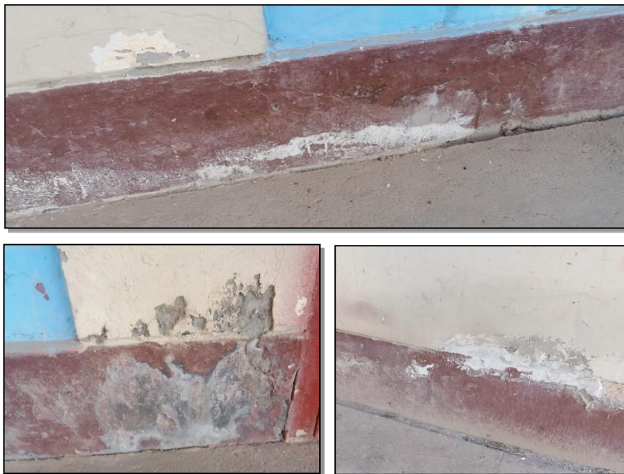
FIGURA 59: Eflorescencias en los sobrecimientos – Primer Nivel
