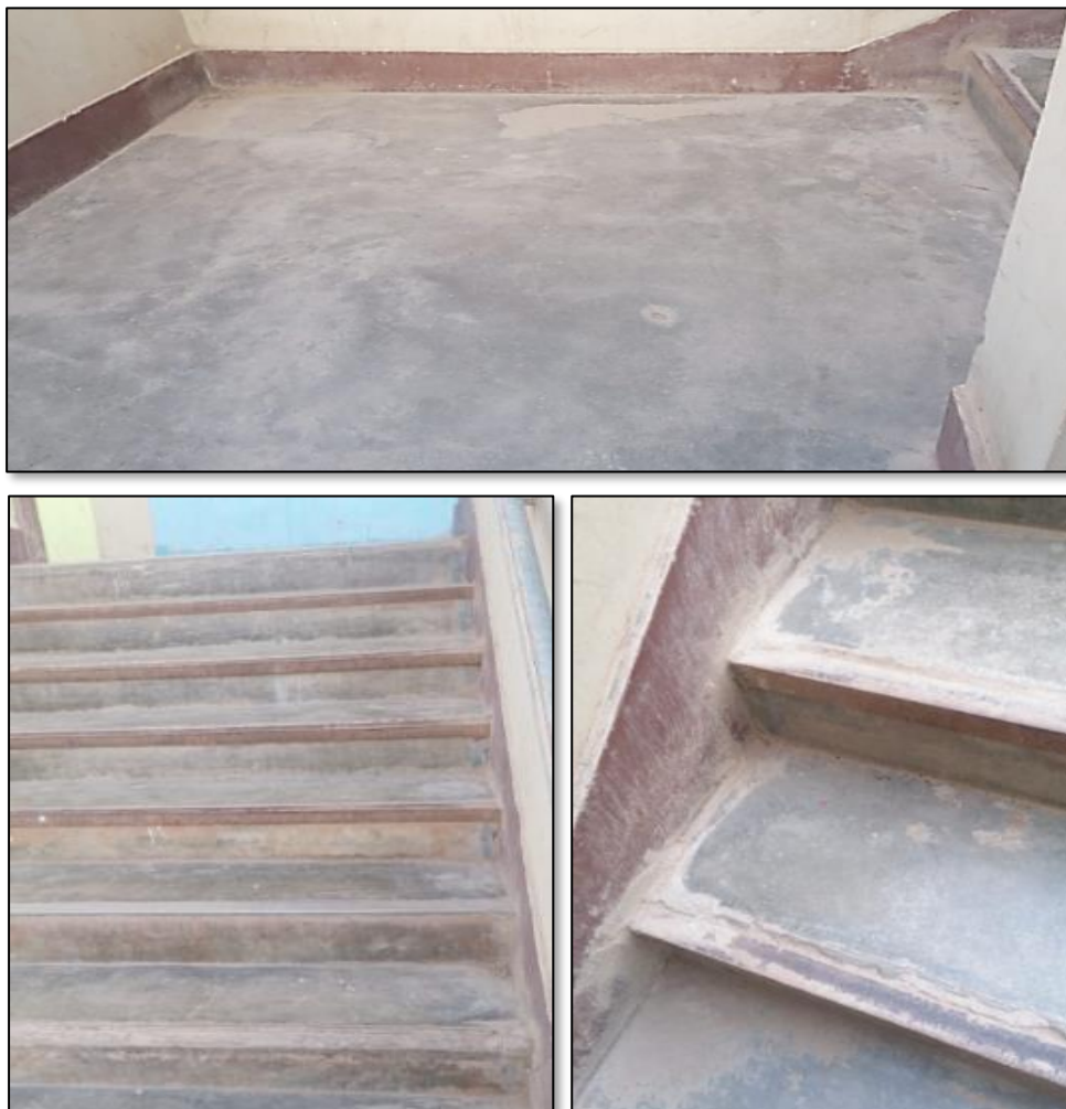
FIGURA 56: Erosión mecánica en las gradas de las escaleras
