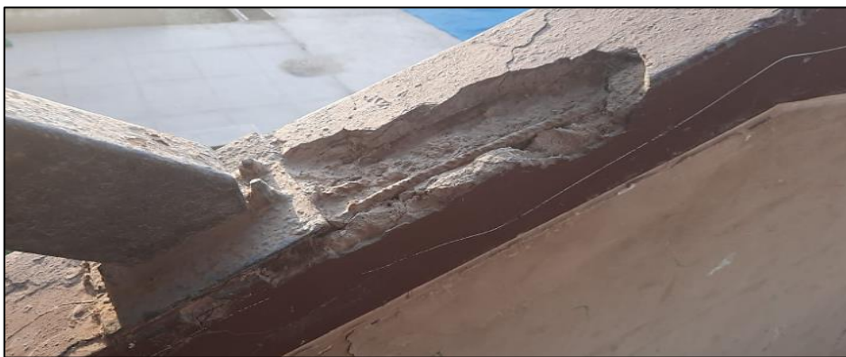
FIGURA 40: Desprendimiento del concreto del pasamanos de la escalera
