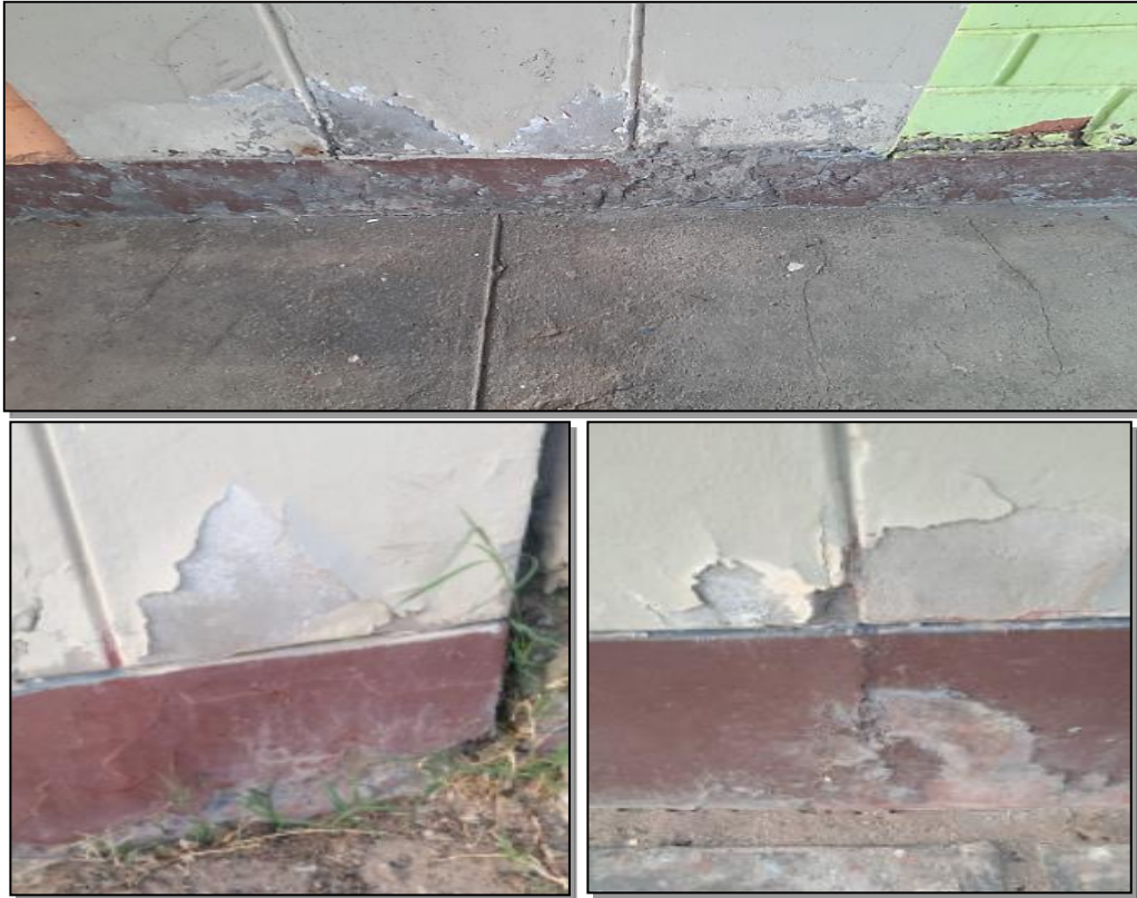
FIGURA 21: Presencia de humedad en las columnas – Primer Nivel
