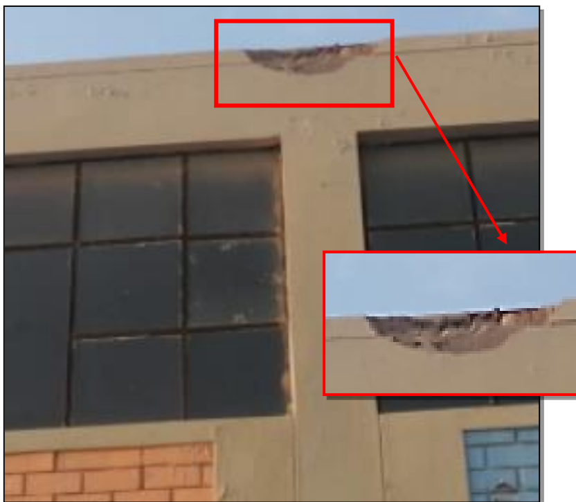
FIGURA 66: Erosión química en la losa del bloque B
