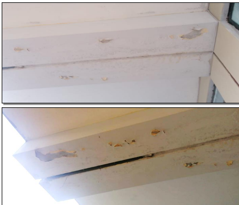
FIGURA 23: Presencia de humedad en las vigas de voladizo – Primer y Segundo Nivel
