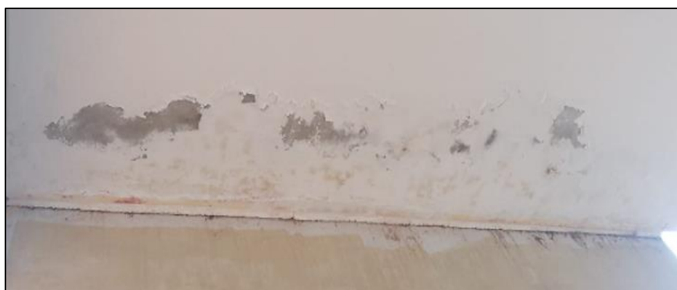
FIGURA 16: Presencia de humedad en las losas – Primer Nivel
