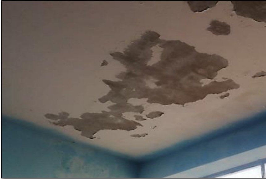
FIGURA 60: Eflorescencias en las losas – Segundo Nivel
