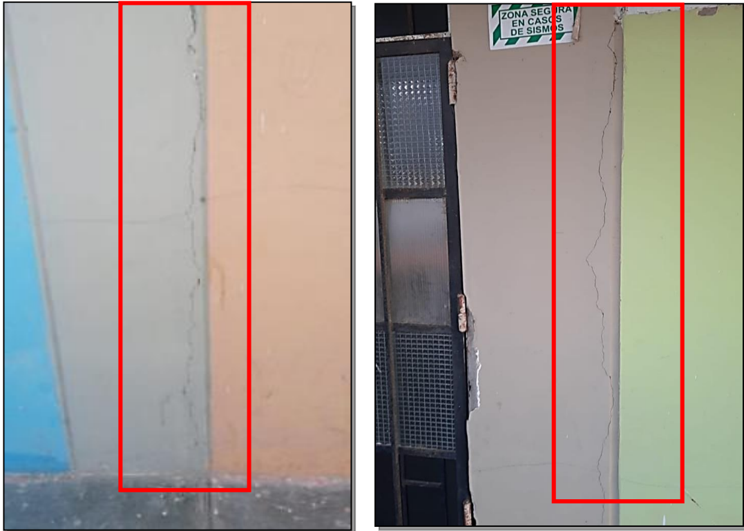
FIGURA 49: Fisuramiento de las columnas– Primer y Segundo Nivel
