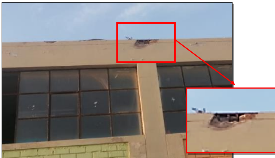
FIGURA 65: Oxidación y corrosión del acero de refuerzo de la losa– Segundo Nivel
