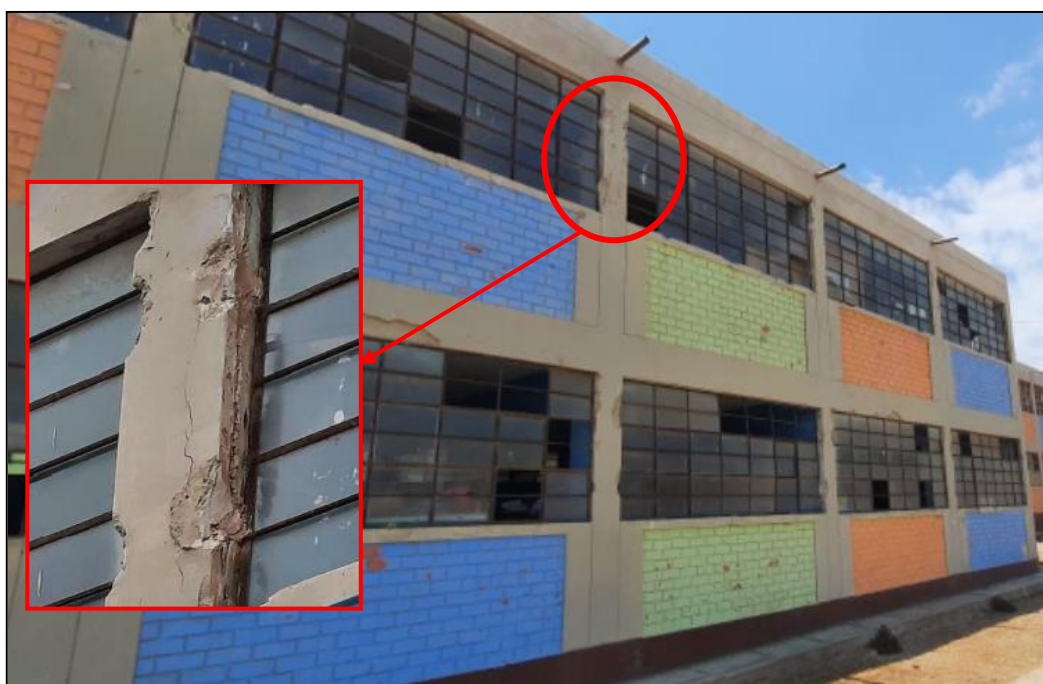
FIGURA 10: Posible colapso por problema de columna corta en la I.E. Nuestra Señora de la Paz
