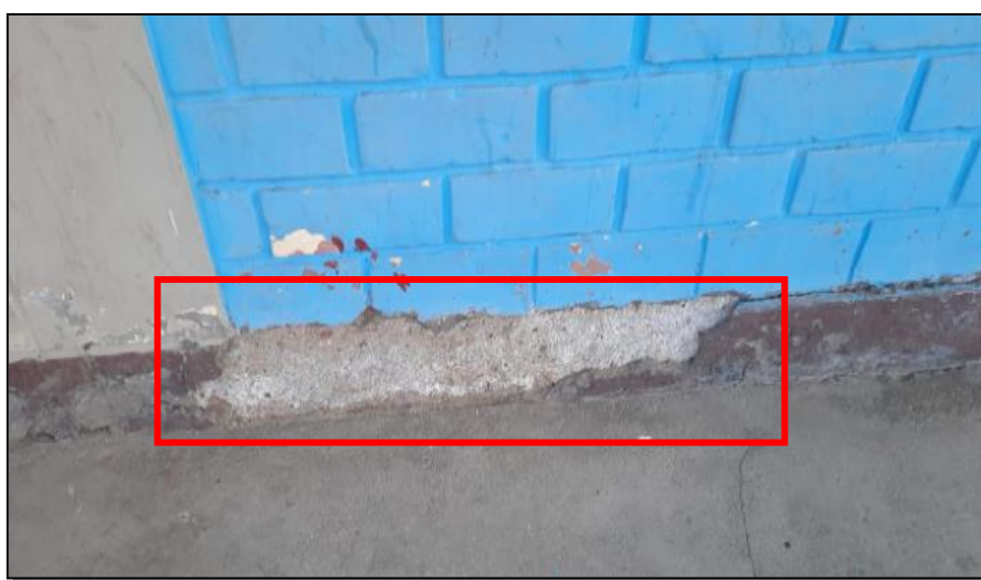
FIGURA 51: Desprendimiento del concreto en sobrecimientos– Primer Nivel
