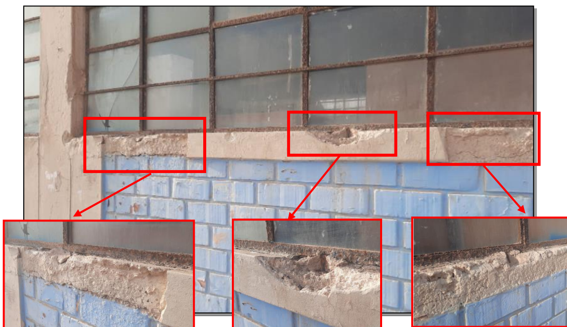
FIGURA 35: Desprendimiento del concreto de las vigas soleras
