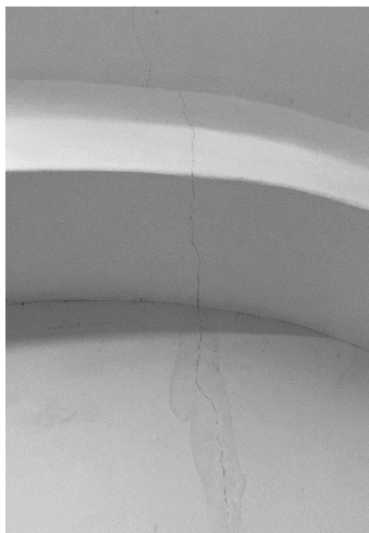
BL1-1: Presencia de fisuras transversales en los arcos de mampostería
