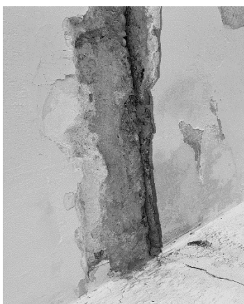
BL2- 4: vista del desprendimiento del recubrimiento y fisuras.
