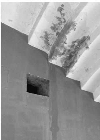
BL1- 2: Presencia de humedad en la losa del graderío (piso 1)
