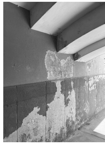
BL1- 3: Vista de humedad en los muros donde se apoya el graderío, desprendimiento del tarrajeo (piso 1).
