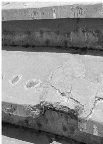
BL2-1: Presencia del acero en estado de corrosión en los asientos de la tribuna
