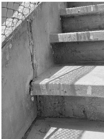
BL1- 1: Vista de agrietamiento en los muros de relleno en el primer piso
