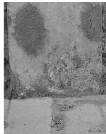
BL3- 1: Vista de la humedad presente en las columnas estructurales de la tribuna
