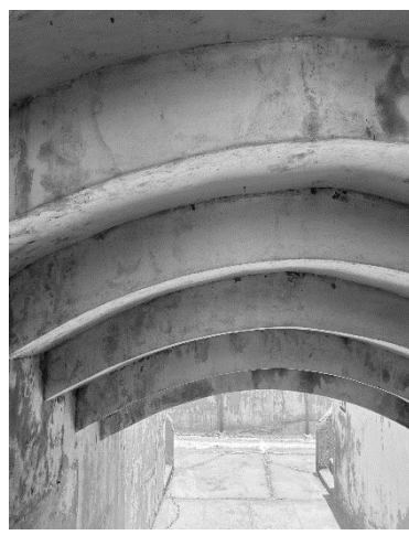
BL2-2: Vista de los arcos de mampostería con presencia de humedad
