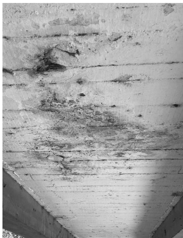
BL1- 1: Vista del fondo de la losa en la tribuna, se observa la presencia de humedad y desprendimiento del recubrimiento (piso 2).
