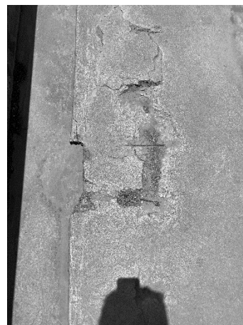
BL3-3: Deterioro en las losas de asiento de la gradería donde se puede observar el acero oxidado
