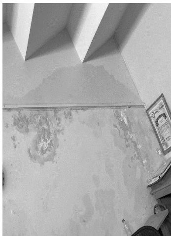
BL1-2: Presencia de humedad en los ambientes internos de la tribuna
