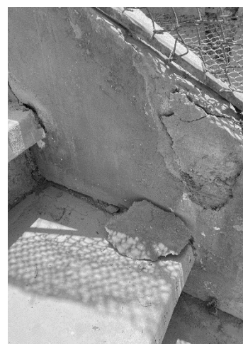
BL3-3: Desprendimiento del recubrimiento de los muros de relleno de la tribuna
