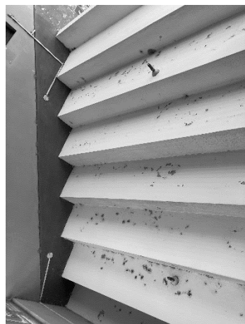
BL2-2: Presencia de humedad en las escaleras de acceso a la tribuna
