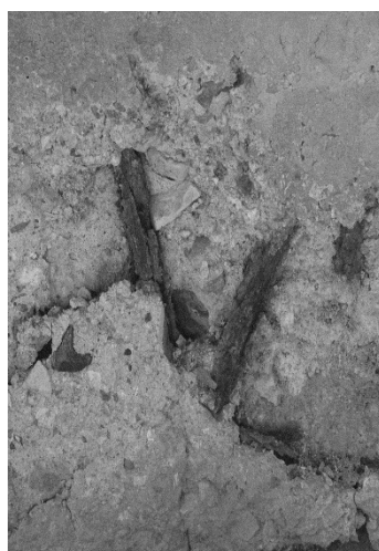
BL3-2: Vista del acero en estado de corrosión expuesto al ambiente
