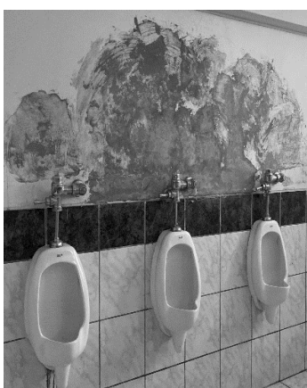
BL3- 2: Vista de humedad en los muros de los servicios sanitarios.
