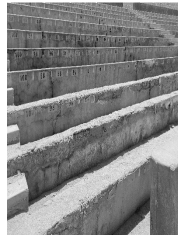
BL1-3: Desprendimiento del tarrajeo en los asientos de los graderíos (1er nivel)
