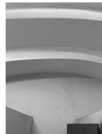
BL2-3: Presencia de fisuramiento en los arcos de mampostería donde se infiltra el agua
