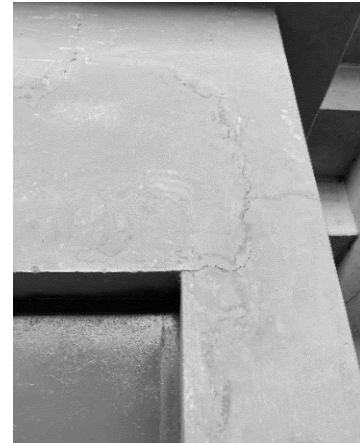
BL3- 1: Vista de la fisura en los muros de relleno debido a una carga excesiva
