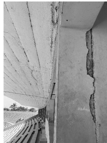
BL2-3: Vista del desprendimiento del tarrajeo de la columna, probablemente debido a una insuficiente junta entre los bloques.
