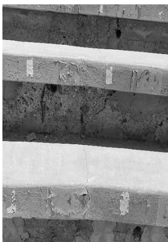
BL2-1: Vista del desprendimiento del recubrimiento por daños de humedad
