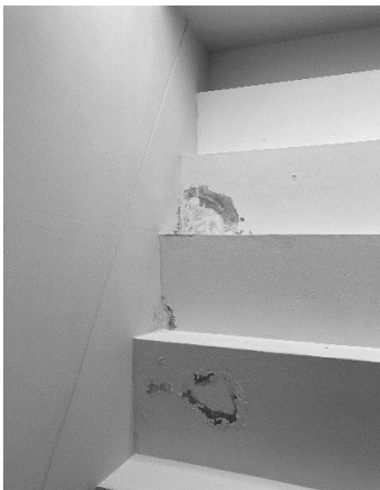
BL3-2: Presencia de humedad en la losa del graderío (Vista desde el primer nivel)
