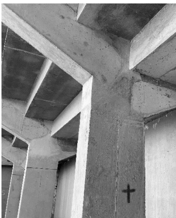
BL3-1: Vista de la humedad acumulada presente en las losas de asiento de la tribuna
