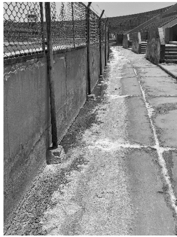
BL1- 2: Presencia de Eflorescencia en los accesos a la tribuna
