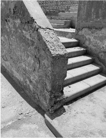
BL1- 1: Vista de la humedad presente en los ladrillos con desprendimiento de su recubrimiento
