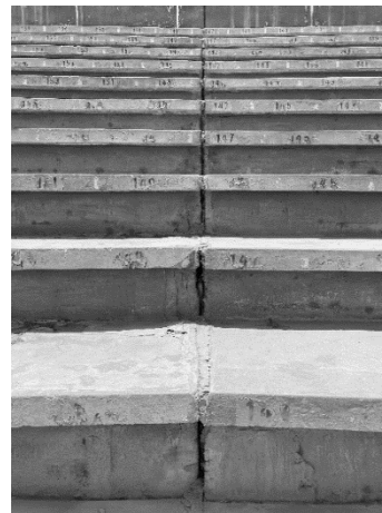
BL1-3: Fisuramiento debido a la insuficiente junta sísmica
