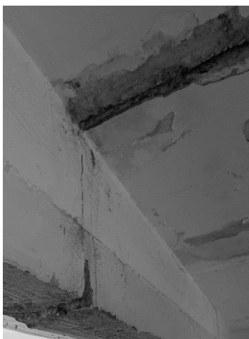
BL2- 1: Vista de la junta entre los bloques B1 y B2, desprendimiento del recubrimiento en las vigas acompañado con manchas de humedad.
