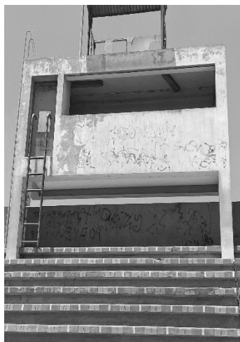
BL2-2: Vista del desprendimiento de pintura y tarrajeo
