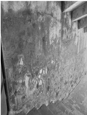
BL2-1: Presencia de manchas producto de la humedad (1er nivel)
