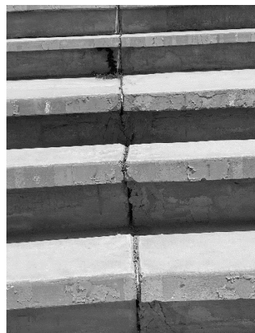
BL1-3: Desprendimiento del recubrimiento debido a la insuficiente junta
