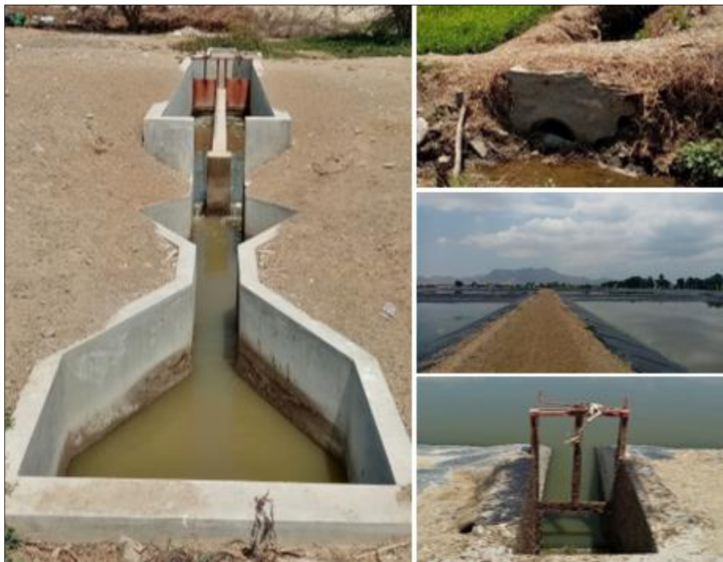
Ilustración 58. Componentes de la PTAR de Cayaltí.
