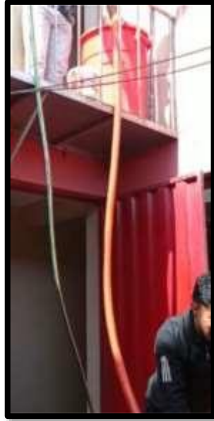
Figura 43 sistema de alimentación de la bomba de ariete
