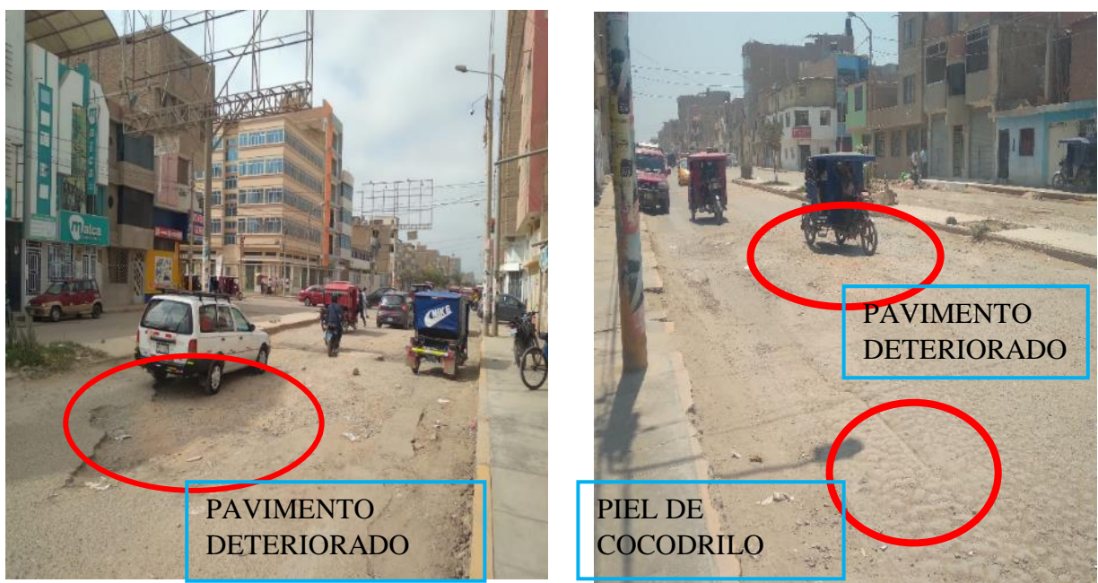
Ilustración 1 Deterioro del pavimento desde las intersecciones de la Av. Balta y Av. México hasta la Av. Chiclayo-Distrito de José Leonardo Ortiz. Fuente: Propia.
