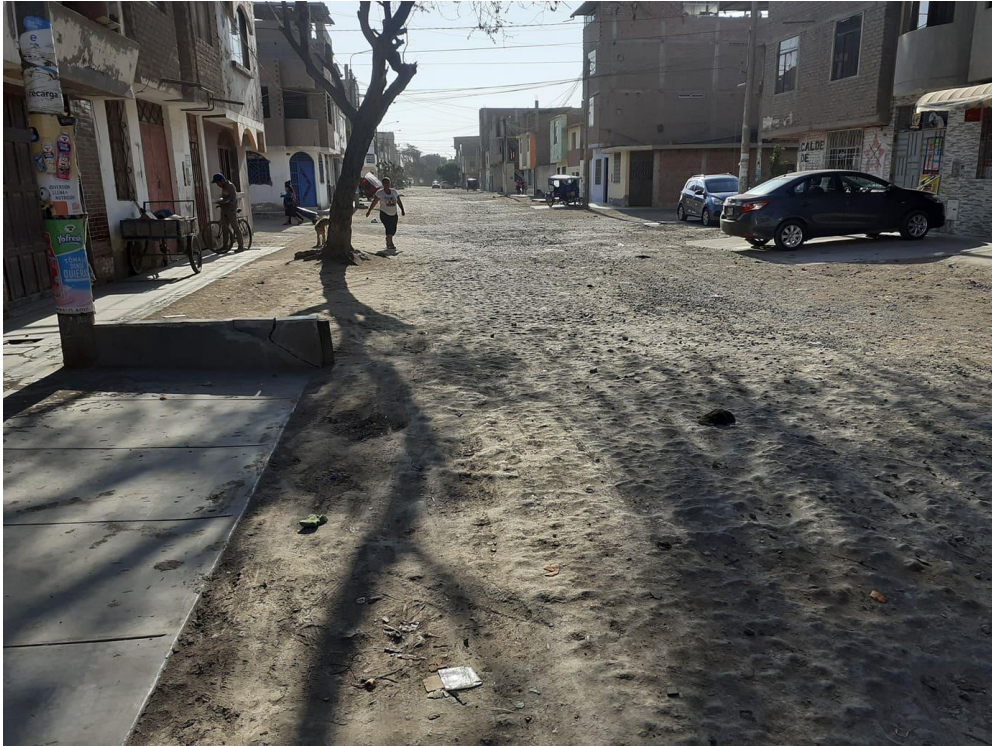
Foto No 2.3: Estado actual de la calle Santa Martha (Contracción poligonal)
