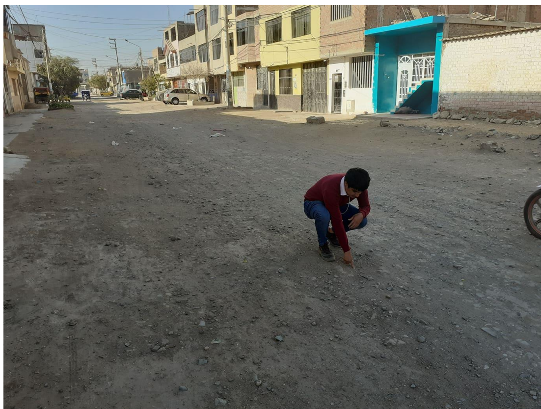
Foto No 2.8: Identificación de problema de desprendimiento de finos
