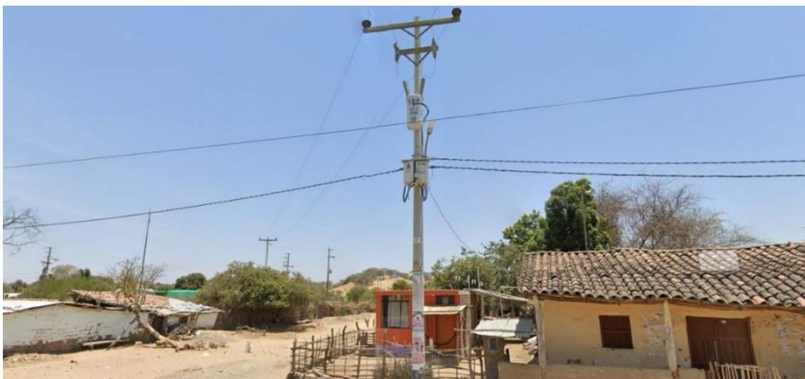
Figura 14. Transformadores en C.P. Ñaupe.
