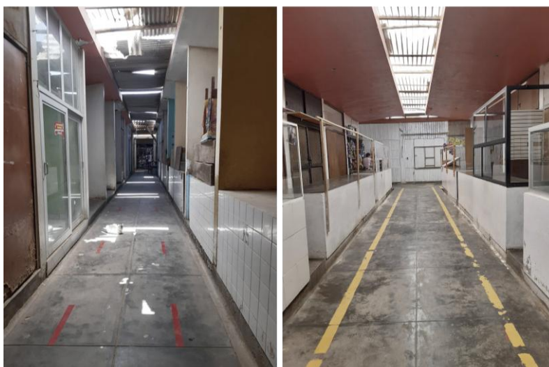
Derecha: Estado actual deteriorado de la estructura; Izquierda: Pasillos de circulación angosta, en desuso. Fuente propia
