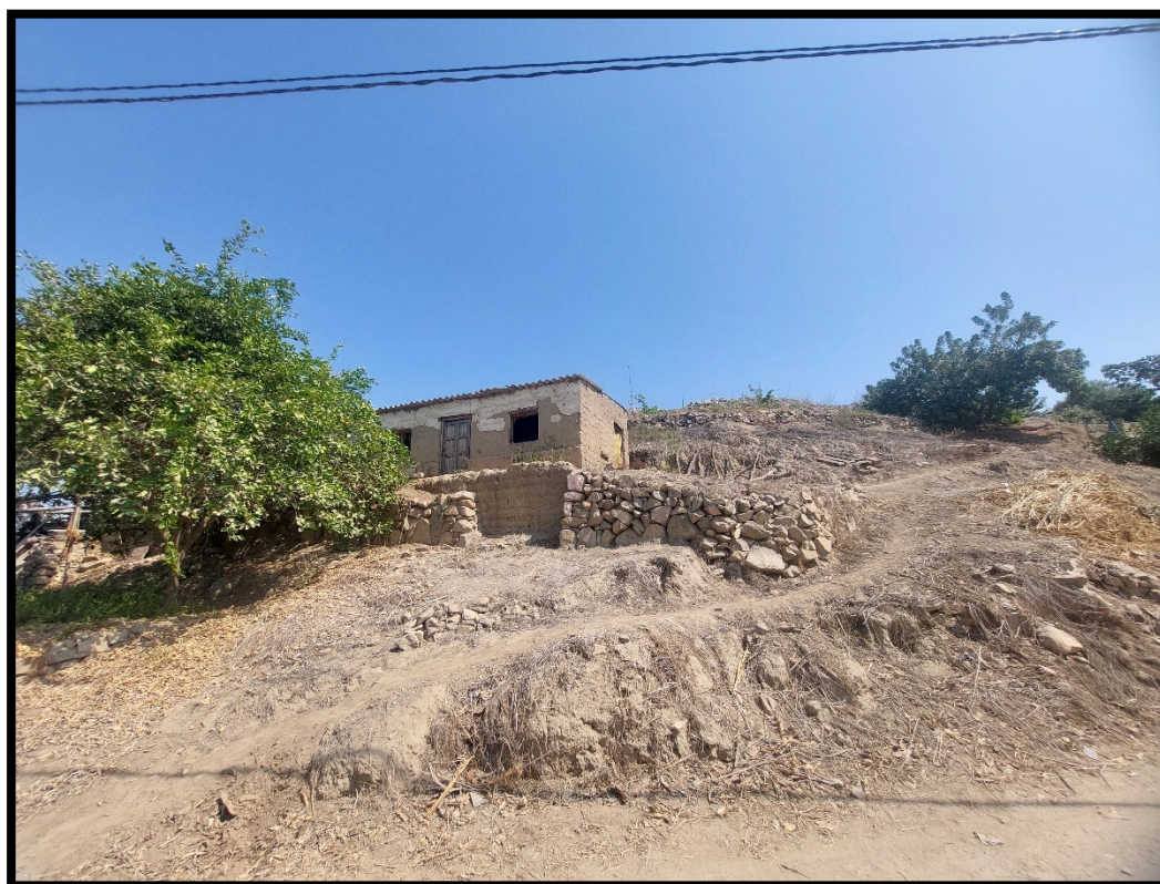
Ilustración 84-. Encuestas - Vivienda de material Adobe - Riesgo Deslizamientos - Vulnerabilidad Muy Alta
