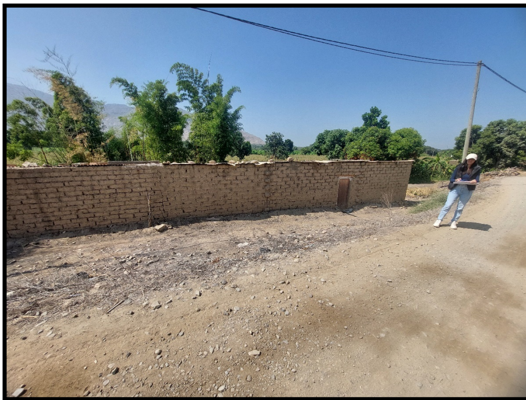
Ilustración 83-. Encuestas - Vivienda de material Adobe - Riesgo Deslizamientos/Huaicos - Vulnerabilidad Muy Alta
