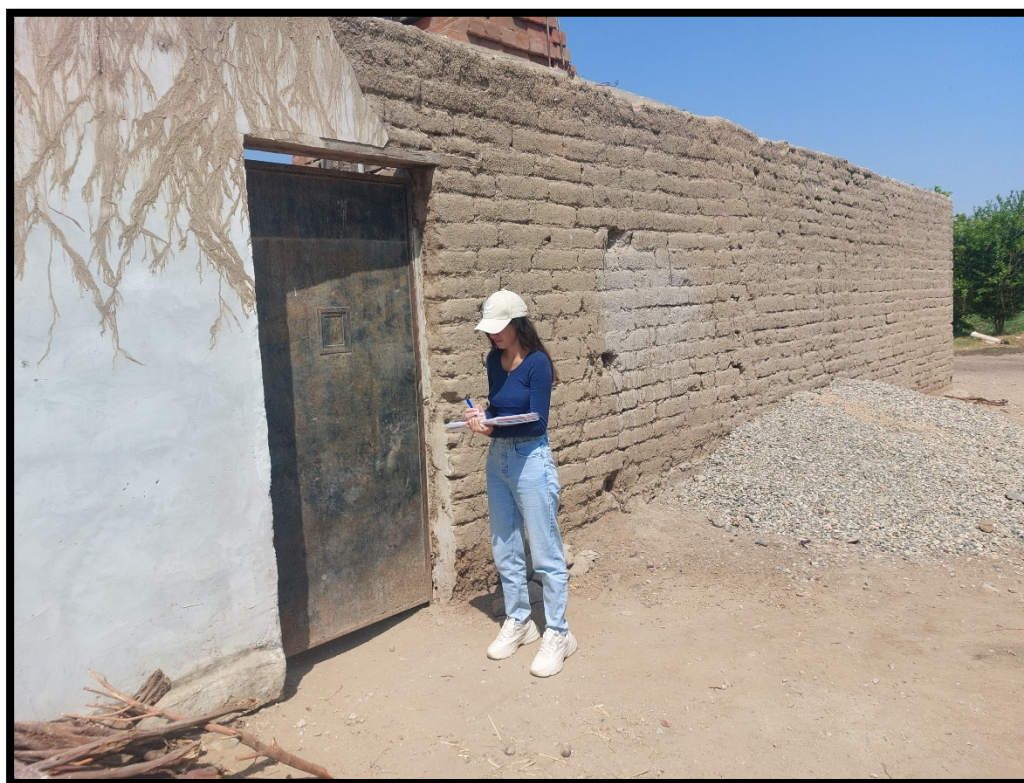
Ilustración 82-. Encuestas - Vivienda de material Adobe - Riesgo Inundación - Vulnerabilidad Muy Alta
