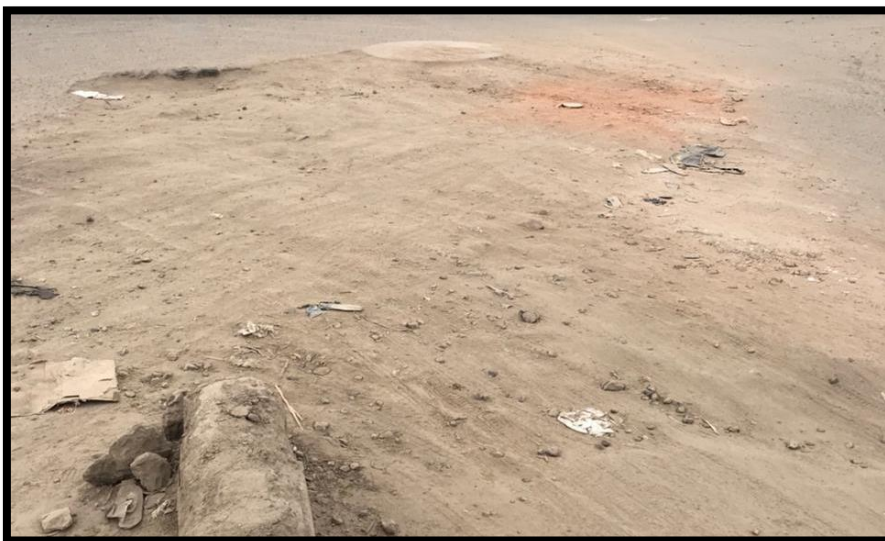
Ilustración 81: Fotografía de deterioro de pavimento en intersección
