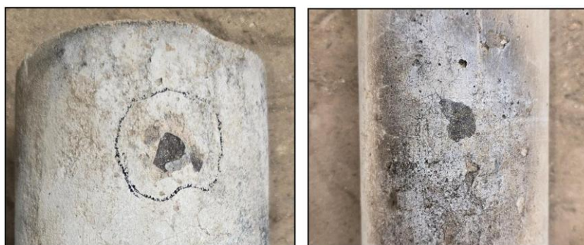
Fig. 69 y 70. Cambio del color del concreto en M4-CT-P y M2-TA-P
