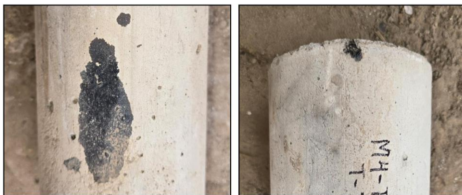
Fig. 73 y 74. Manchas en el concreto en M6-TA-P y M4-TA-P
