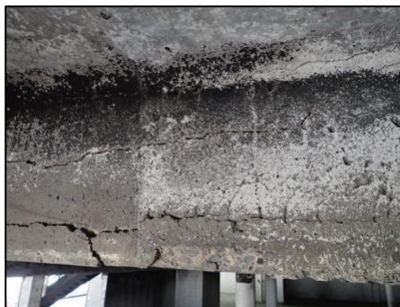
Fig 3. Grietas a lo largo de una viga de hormigón armado debido a la exposición del fuego [27].
