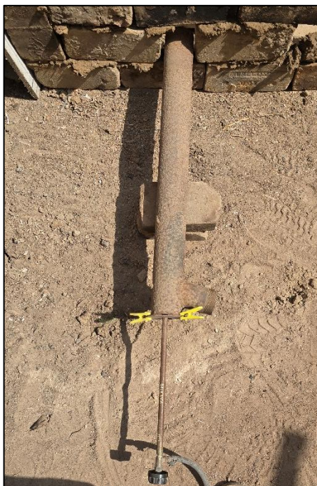
Fig. 47. Rociador lateral del sistema.
