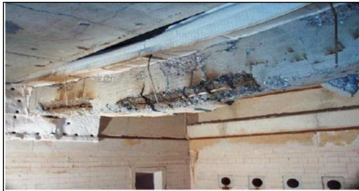
Fig 2. Fenómeno de spalling en vigas de concreto armado [21].
