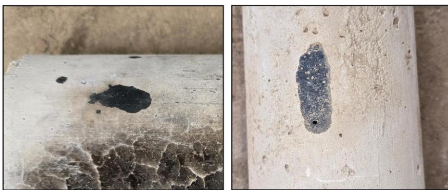
Fig. 71 y 72. Manchas en el concreto en M6-CT-P y M5-TA-P
