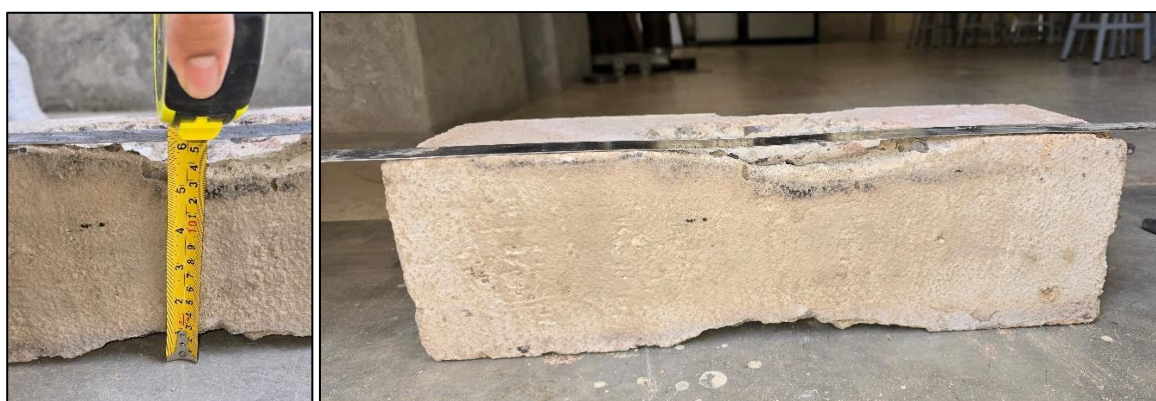
Fig. 58 y 59. Medida de la reducción de sección y spalling en viga armada.
