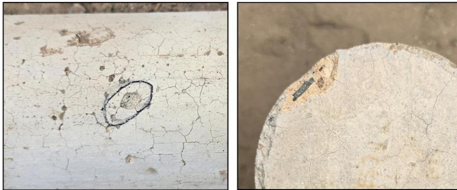
Fig. 60 y 61. Spalling en muestra M7-CT-P y M6-CT-P
