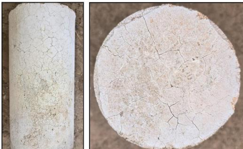
Fig. 54 y 55. Fisuración del concreto a temperaturas mayores a 600°
