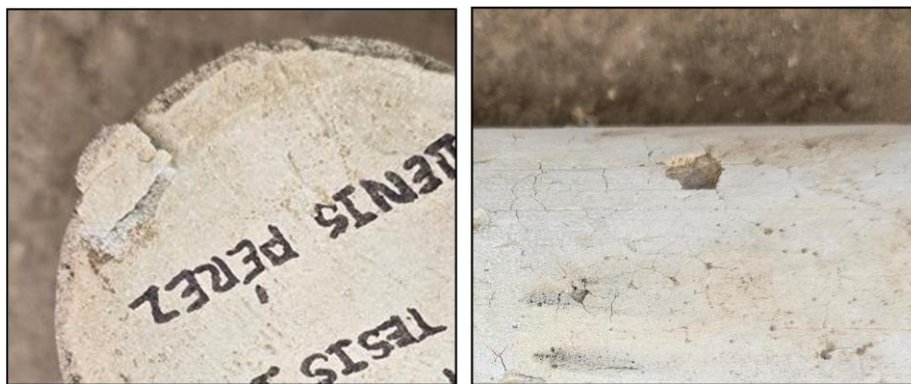
Fig. 62 y 63. Spalling en muestra M4-TA-P y M5-TA-P
