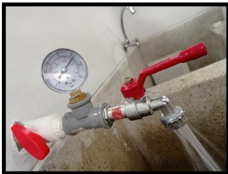
Figura N°6. Preparación de manómetro a 10 lb/in 2
