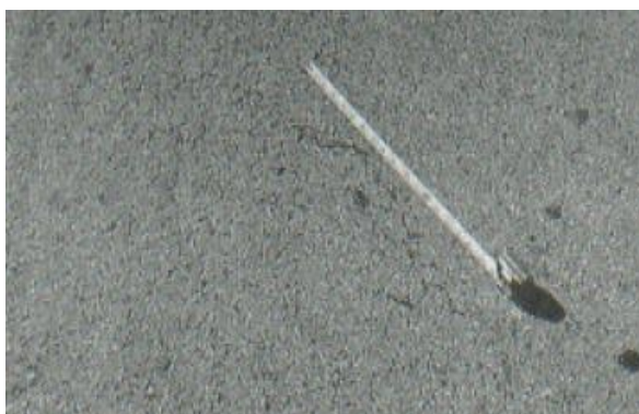
Ilustración 46. Fisuras parabólicas -Baja severidad.
