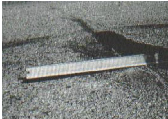
Ilustración 12. Abultamientos y hundimientos -Media severidad.
