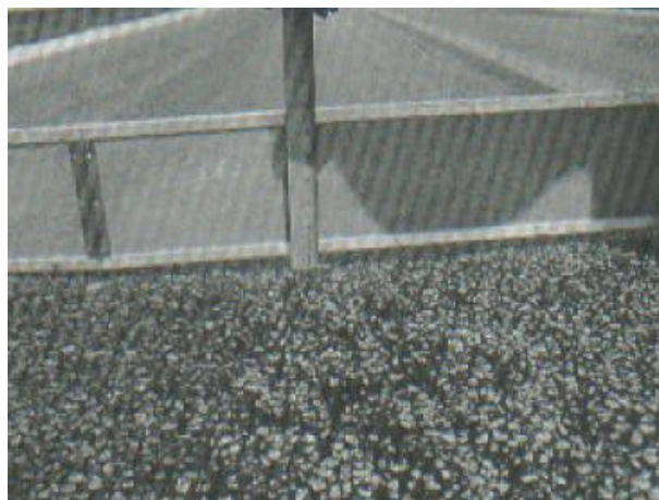
Ilustración 41. Ahuellamiento -Media severidad.
