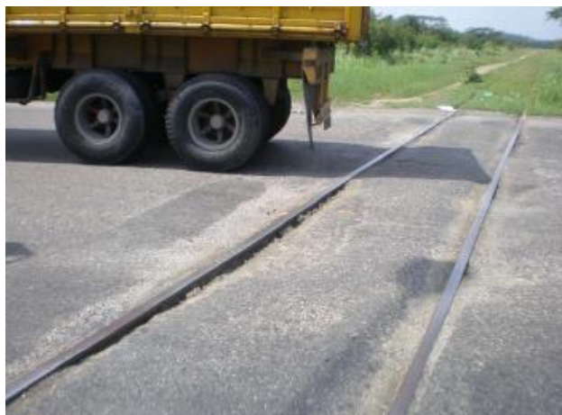
Ilustración 38. Cruce de vía férrea - Media severidad.
