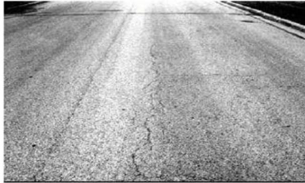
Ilustración 3. Piel de cocodrilo - Media severidad.
