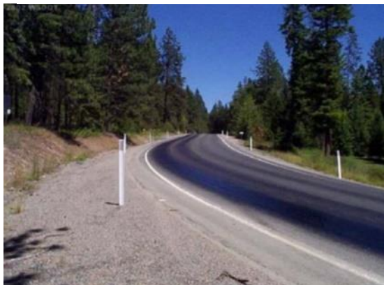
Ilustración 7. Exudación - Alta severidad.
