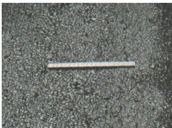
Ilustración 50. Desprendimiento de agregados -Baja severidad.
