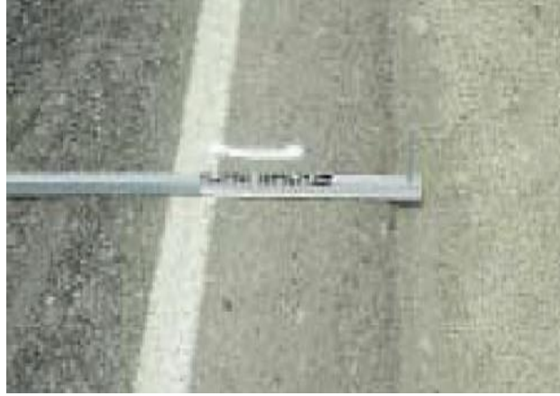
Ilustración 25. Grieta de reflexión de juntas - Media severidad.
