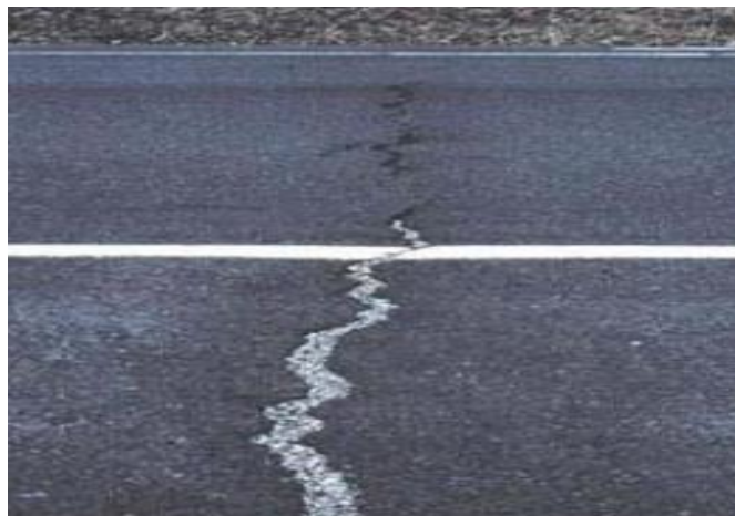
Ilustración 29. . Fisuras longitudinales y transversales - Alta severidad.
