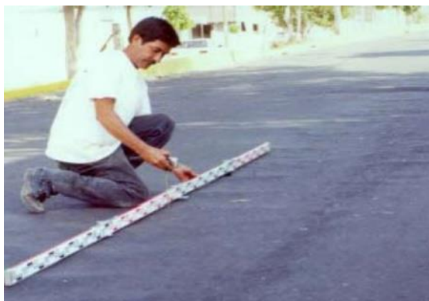
Ilustración 15. Corrugaciones -Media severidad.
