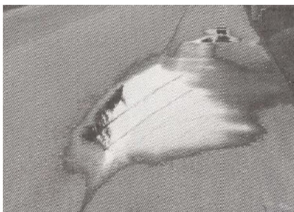
Ilustración 17. Depresiones - Baja severidad.
