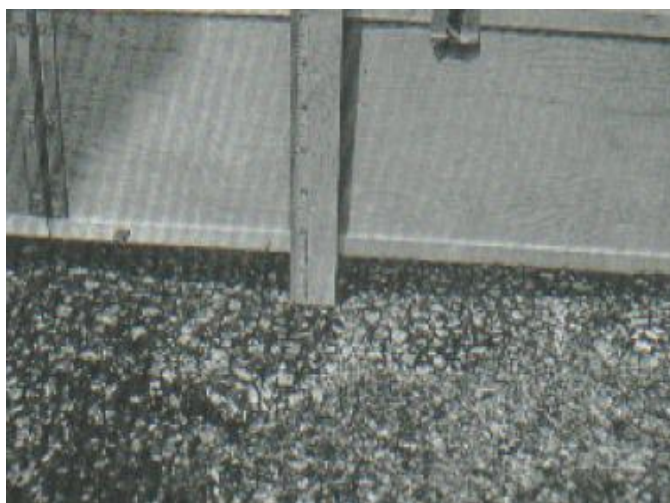
Ilustración 42. Ahuellamiento - Alta severidad.
