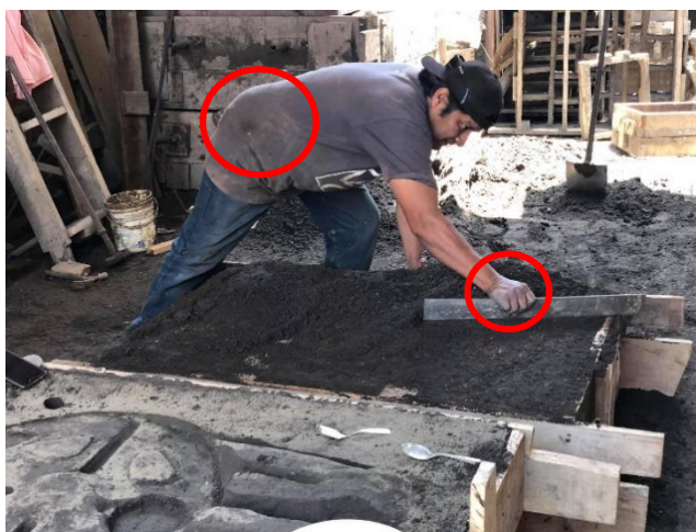
Figura 96. Operario 1 sin EPP'S expuestos a factores de riesgo Fuente: San Simón S. A. C.
