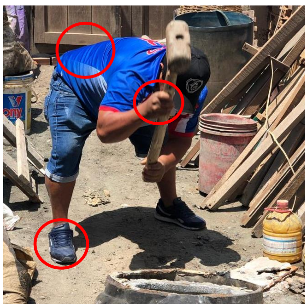
Figura 99. Operario 1 sin EPP'S expuestos a factores de riesgo
