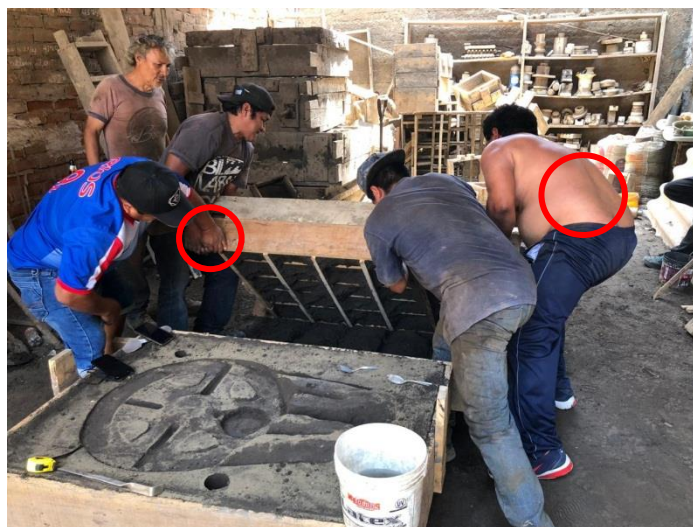
Figura 98. Operario 1 y 2 sin EPP'S expuestos a factores de riesgo
