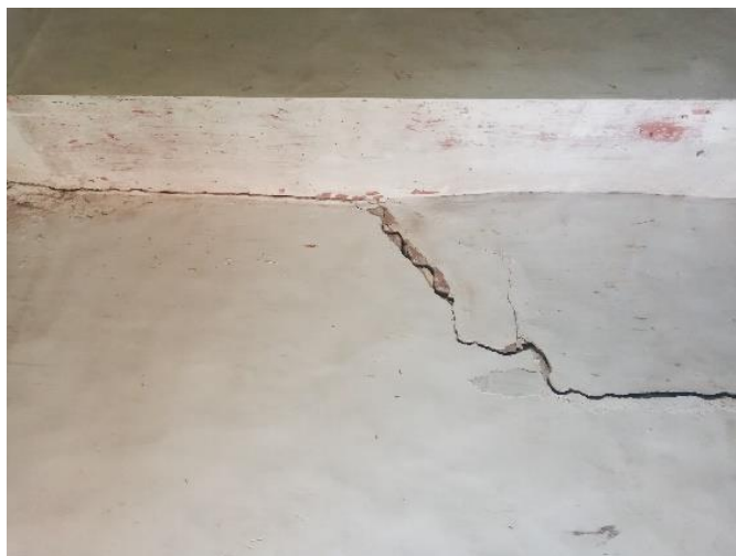
Figura 67. Fisuras en muros de adobe.
