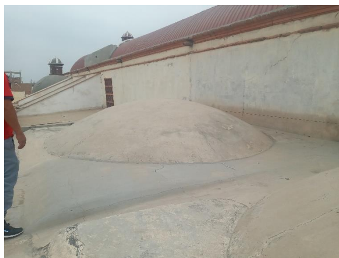
Figura 63. Cúpulas baídas que presenta eflorescencias.
