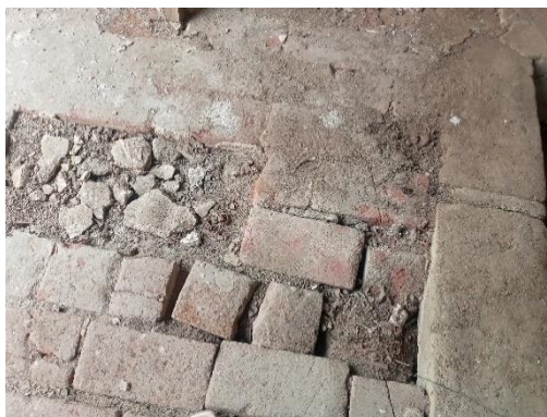
Figura 66. Ladrillos expuestos sin piso y mortero resquebrajado.
