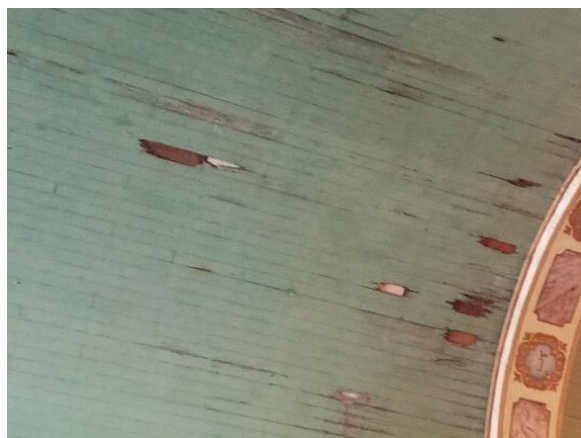
Figura 69. Bóveda encamonada que presenta elementos sueltos por polillas.
