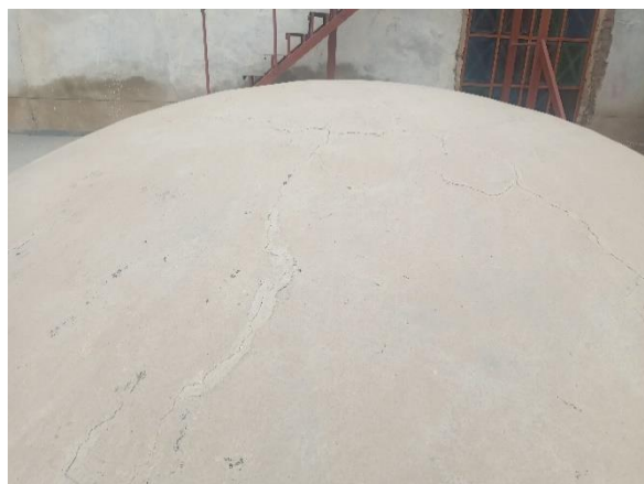
Figura 62. Cúpulas baídas las cuales presentan fisuras.
