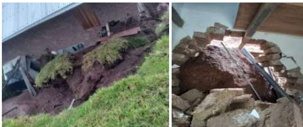
Figura N° 1. Viviendas afectadas por las intensas lluvias en C.P Udima
