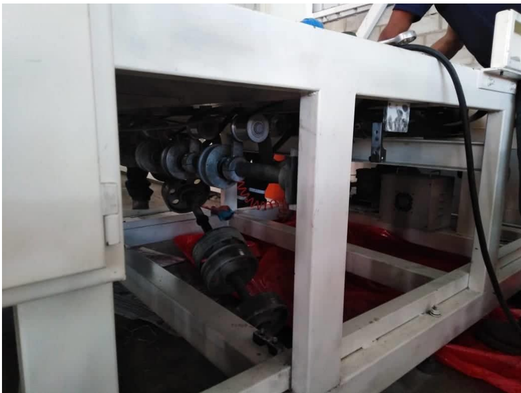
Figura 9. Falla mecánica en la convertidora 1
